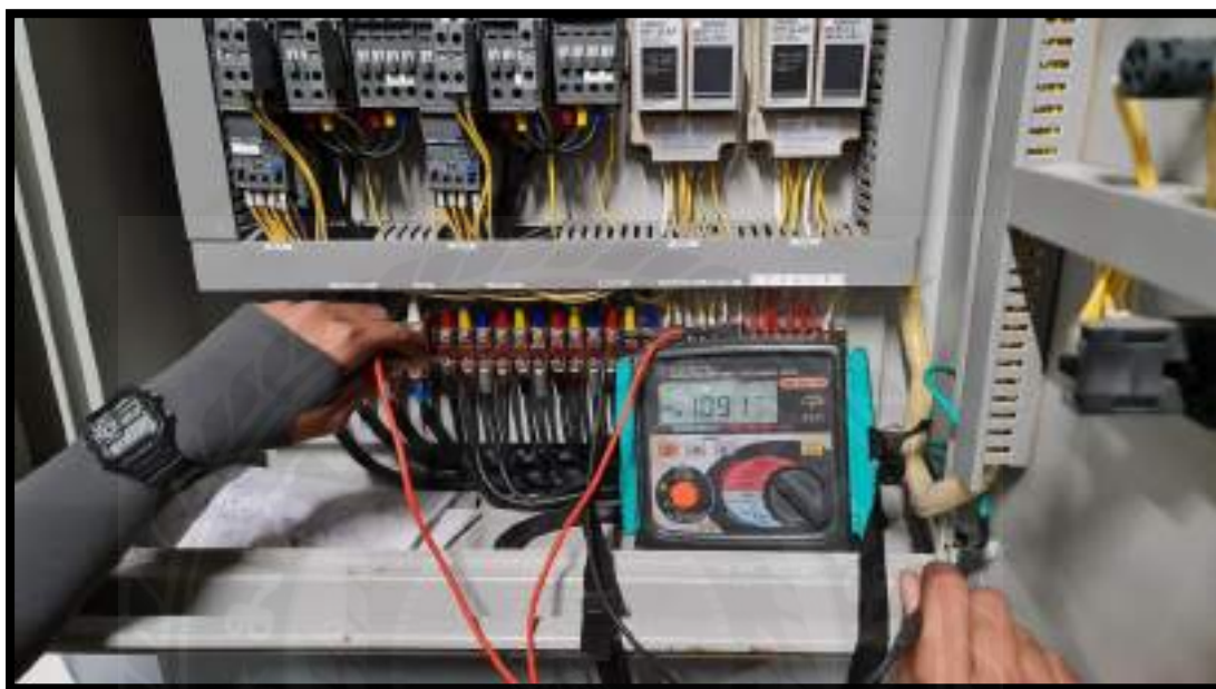
รูปที่ 4.13 ตัวอย่างการตรวจเช็คค่าความต้านทานของฉนวนของ U-G
