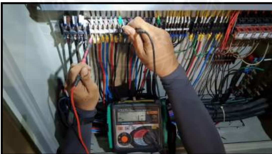
รูปที่ 4.16 ตัวอย่างการตรวจเช็คค่าความต้านทานของฉนวนของ U1-G
