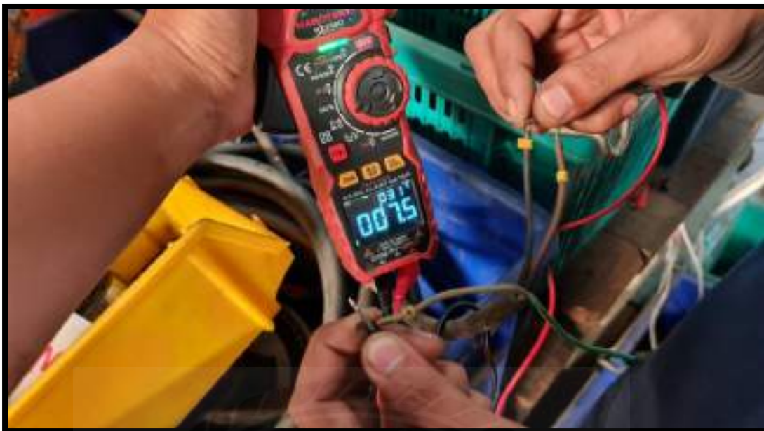
รูปที่ 4.6 การตรวจเช็คค่าความต้านทานของ V-W
