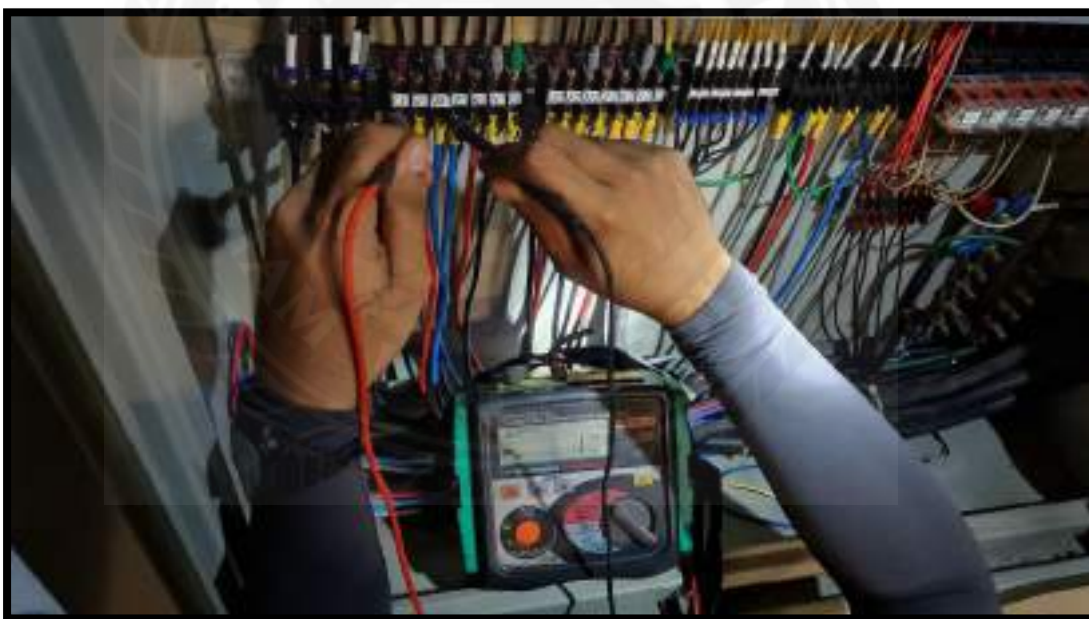
รูปที่ 4.20 ตัวอย่างการตรวจเช็คค่าความต้านทานของฉนวนของ U1-W1
