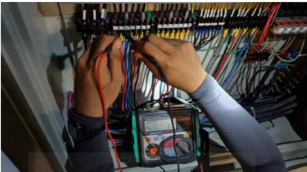
รูปที่ 4.19 ตัวอย่างการตรวจเช็คค่าความต้านทานของฉนวนของ U1-V1
