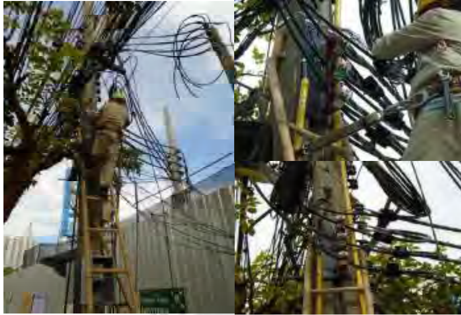
รูปที่ 4.12 ลักษณะการติดตั้ง CT บนยอดเสา และการเชื่อมต่อสายเมนของลูก้ากับ กฟน.
