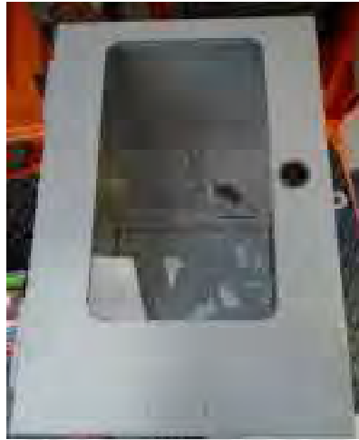
รูปที่ 4.2 ตู้เครื่องวัดไฟฟ้า
