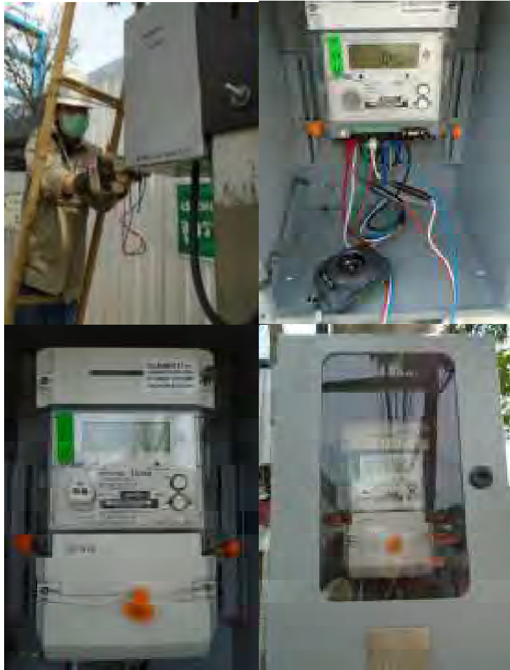
รูปที่ 4.16 การวัดค่าแรงดันและลำดับเฟส
