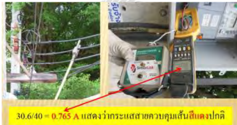
รูปที่ 4.25 การวัดค่ากระแสไฟฟ้าด้าน Primary กับ Secondary ของ CT
