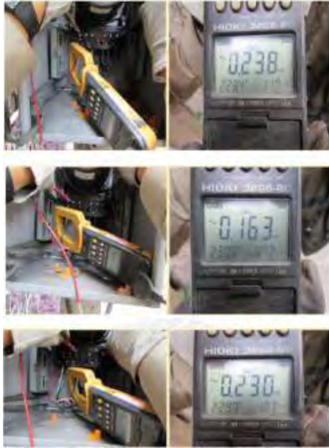
รูปที่ 4.26 วิธีการใช้ Clamp on Power Meter วัดค่าจากสายควบคุม
