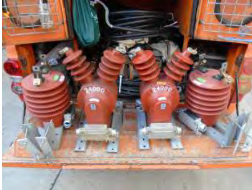
รูปที่ 4 CT, VT ของเครื่องวัดไฟฟ้าแรงดัน 24 กิโลโวลต์
