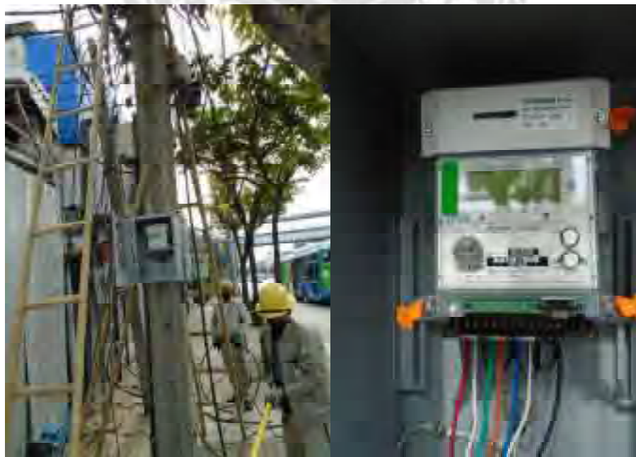
รูปที่ 4.13 การติดตั้งตู้และต่อสายควบคุมเข้าเครื่องวัดไฟฟ้า
