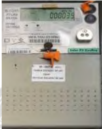
รูปที่ 2.17 เครื่องวัดไฟฟ้าประเภท VSPP
