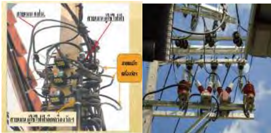
รูปที่ 2.24 การต่อสายเมนกับ CT และ VT
