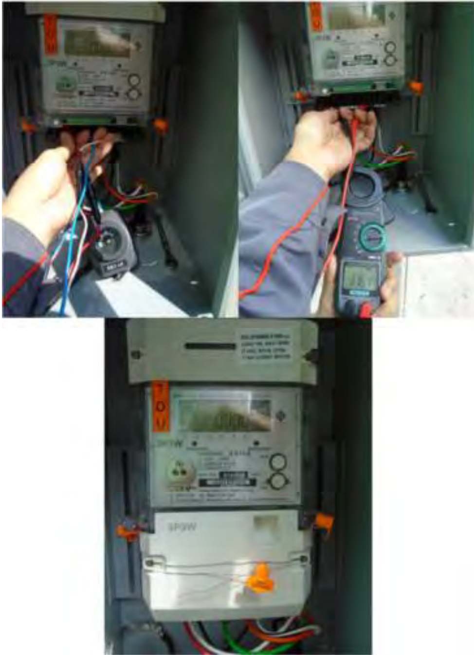
รูปที่ 4.24 การวัดค่าแรงดันและลำดับเฟสของเครื่องวัดไฟฟ้า
