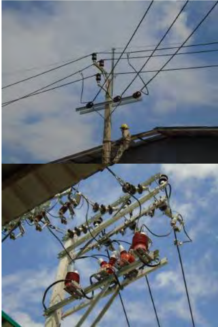
รูปที่ 4.23 การใส่ Hot Line Stirrup Clamp และ สับ Drop Out Fuse
