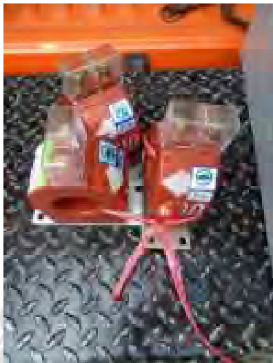
รูปที่ 4.4 CT ระบบแรงดัน 230/400 V พิกัดกระแส 400/5 A
