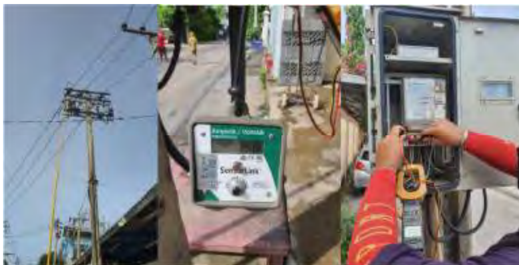
รูปที่ 4.29 การวัดค่ากระแสและวัดแรงดันระหว่างสายเมนกับสายควบคุม
