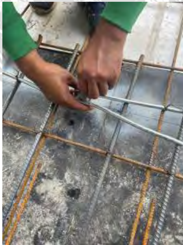
รูปที่ 4.15 ขั้นตอนการติดตั้งระบบ Galvanized Steel
