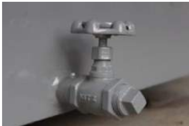
รูปที่ 4.2 วาล์วถ่ายน้ำมันของหม้อแปลงไฟฟ้า
