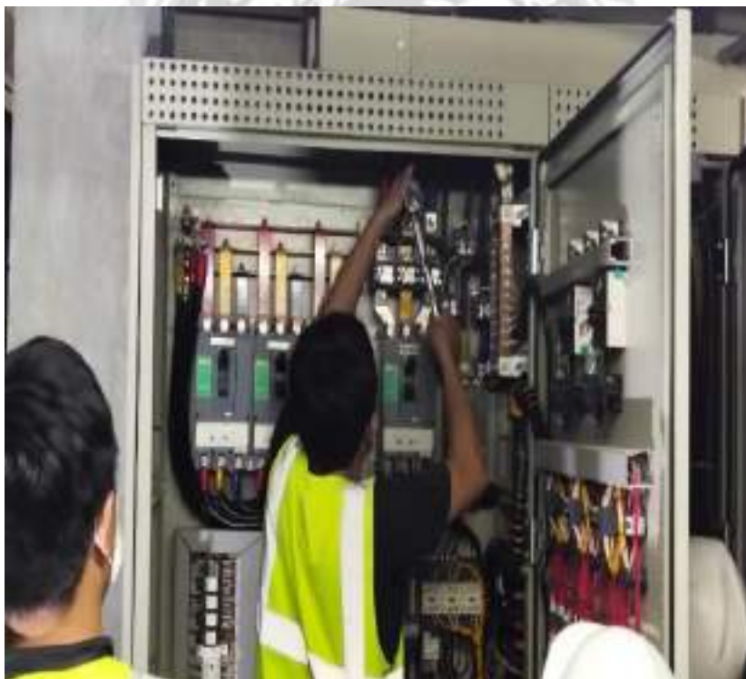
ตรวจสภาพสายไฟภายในตู้เมน
