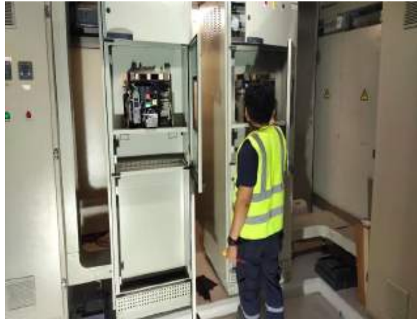
รูปที่ 4.12 ตรวจสอบสายไฟภายนอกตู้ควบคุมระบบไฟฟ้าหลัก (Main Distribution Board : MDB) 4.3 การซ่อมบำรุงตู้โหลดเซ็นเตอร์
