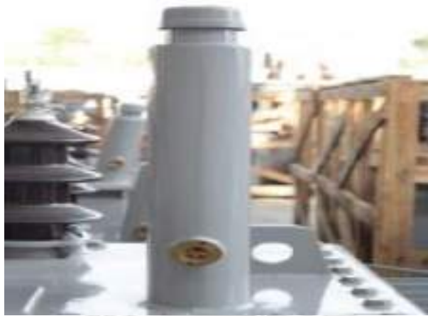
รูปที่ 4.9 อุปกรณ์วัดความดันหม้อแปลงไฟฟ้า
