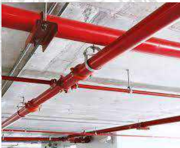
รูปที่ 2.5 ท่อระบบดับเพลิง.
