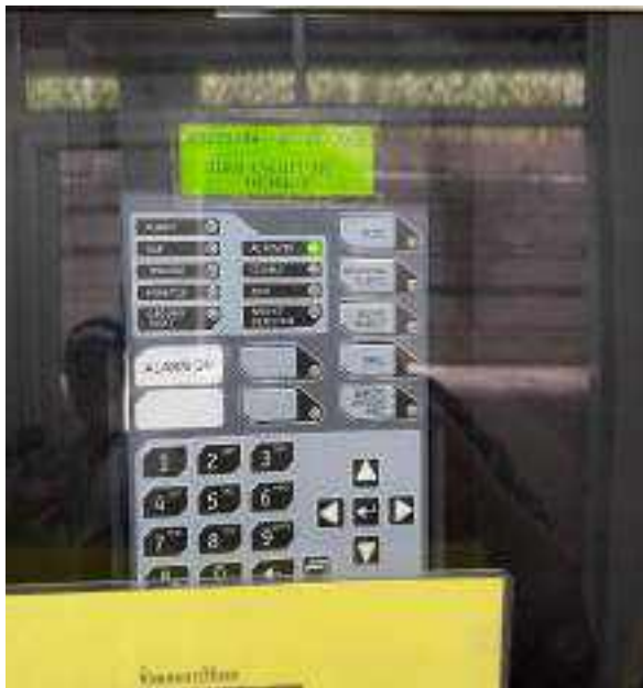
รูปที่ 4.4 ตู้ Fire Alarm System
