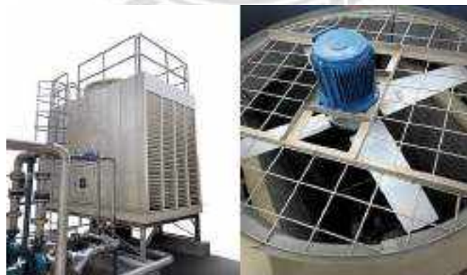
รูปที่ 4.15 หอระบายความร้อน CT
