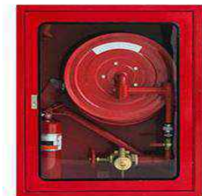
รูปที่ 4.13 ตู้และสายดับเพลิง
