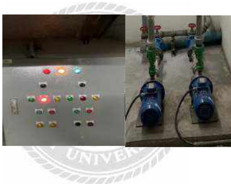
รูปที่ 4.17 ตู้ควบคุมระบบ SLR , SWP และ ระบบปั้มน้ำดี WP
