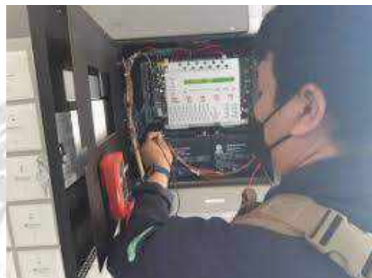
รูปที่ 4.5 ตรวจสอบเช็คระบบ Fire Alarm System
