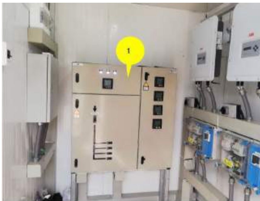
ดำเนินการงานตรวจรับระบบไฟฟ้า
