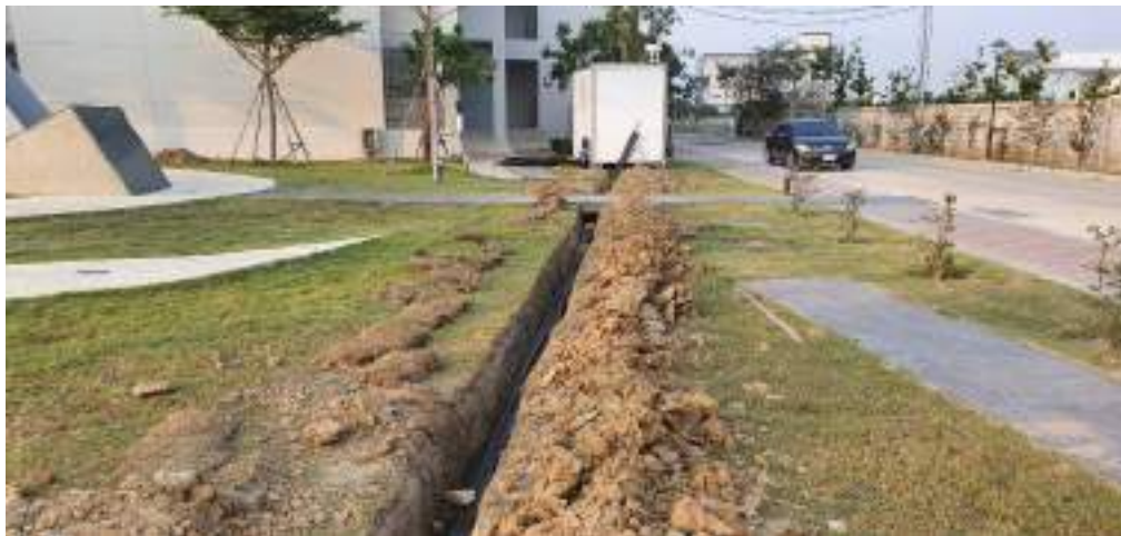
ดำเนินการงานเดินท่อร้อยสายไฟแผงโซล่าเซลล์
