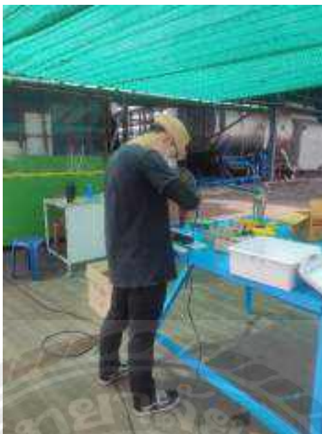
รูปที่ 2.22 เป็นการเตรียมอุปกรณ์สำหรับการติดตั้งระบบไฟส่องสว่าง
