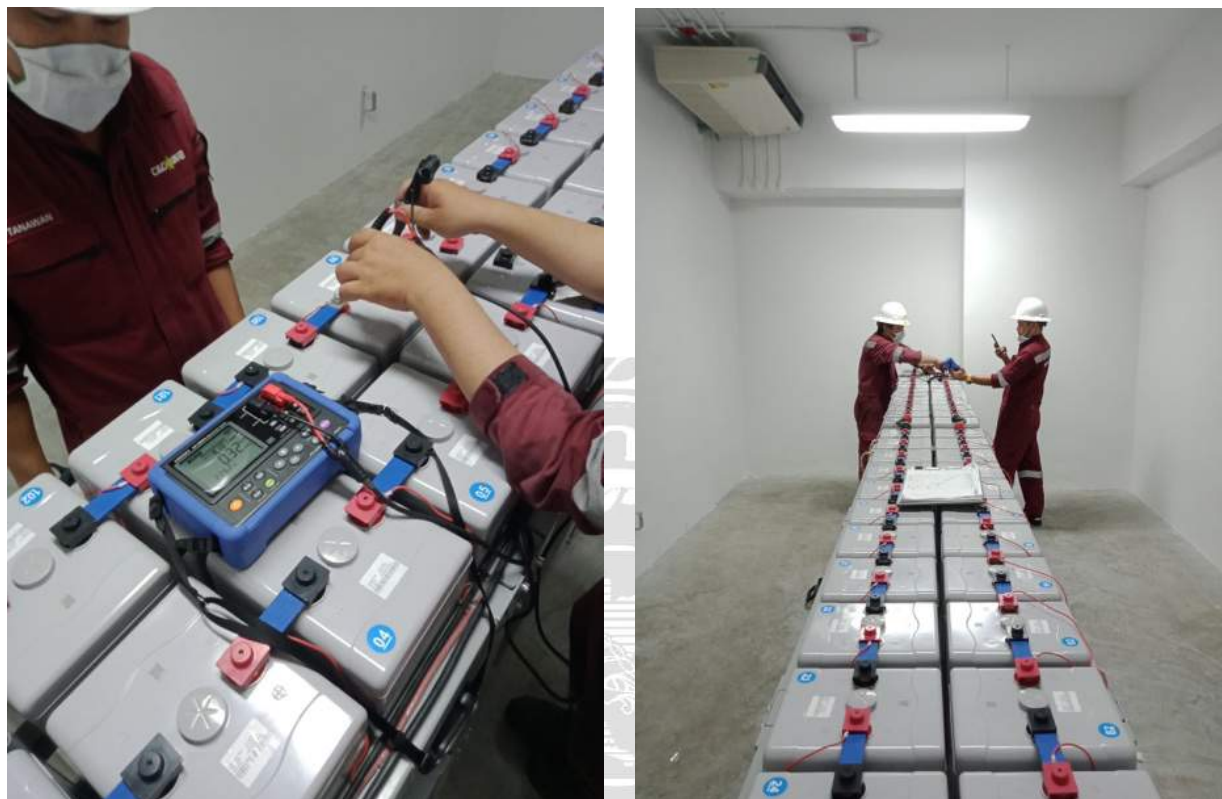
รูปที่ 4.1.2 PM UPS&amp;Baรูปtttery charger
