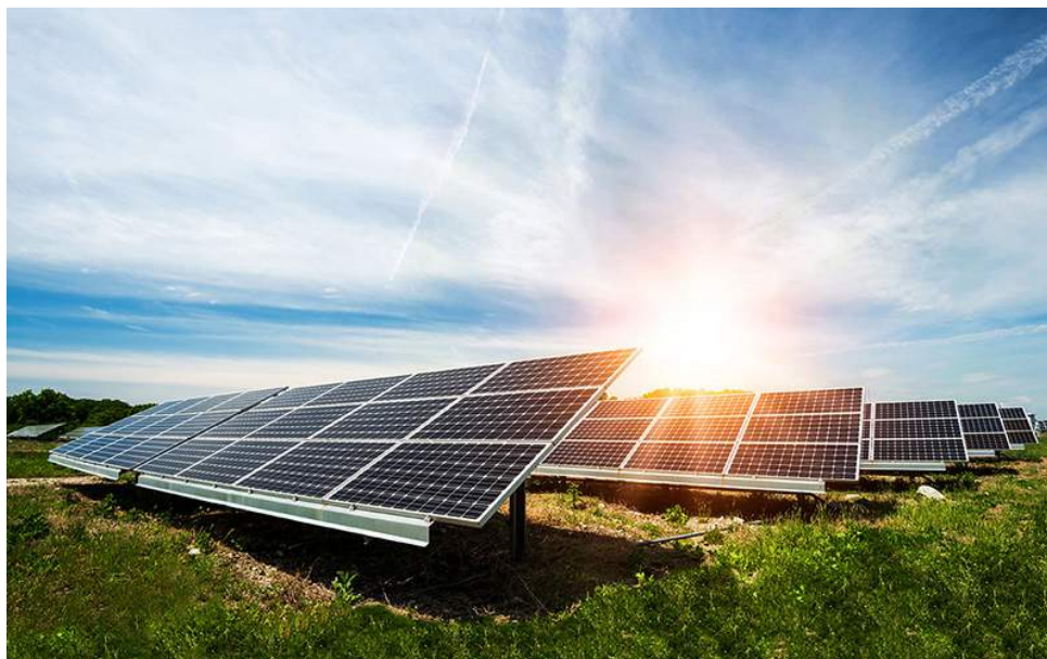
รูปที่ 2.26 โรงไฟฟ้าพลังงานแสงอาทิตย์
