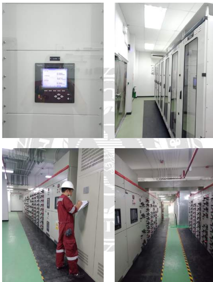
รูปที่ 4.1.3 PM MCC Room
