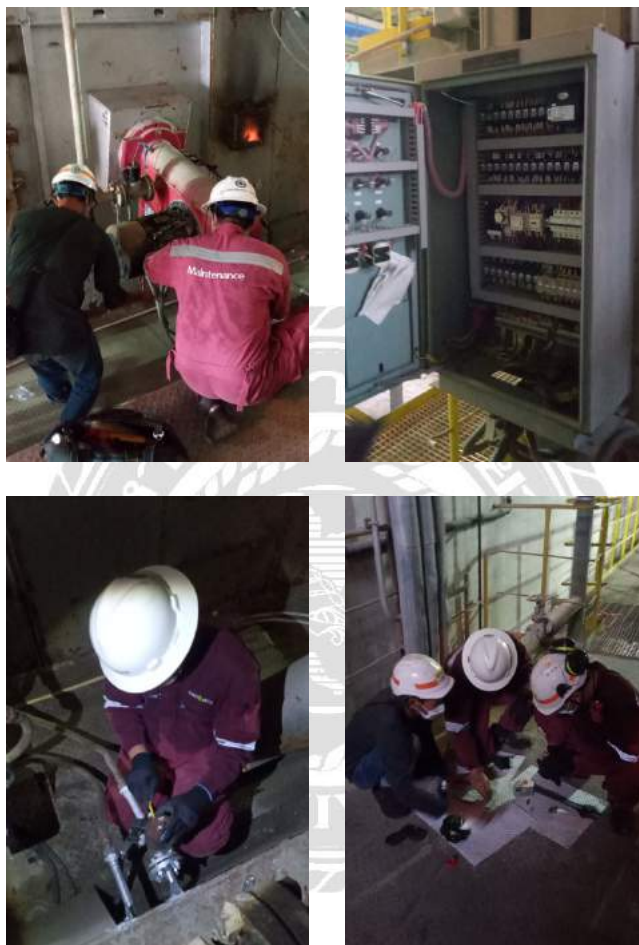
รูปที่ 4.2.8 Test ระบบ Burnout Boiler 1-2
