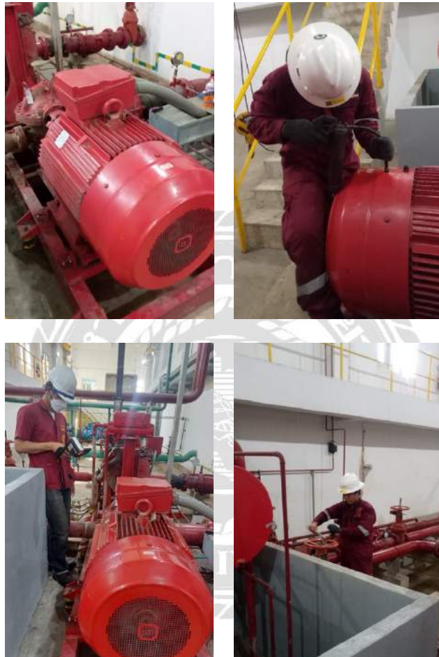
รูปที่ 4.1.16 Fire Pump
