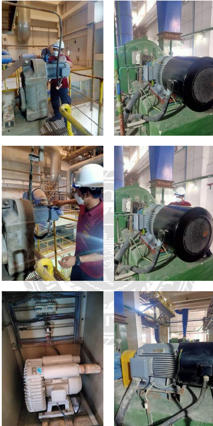
รูปที่ 4.1.7 PM Zone Boiler 1 - 2
