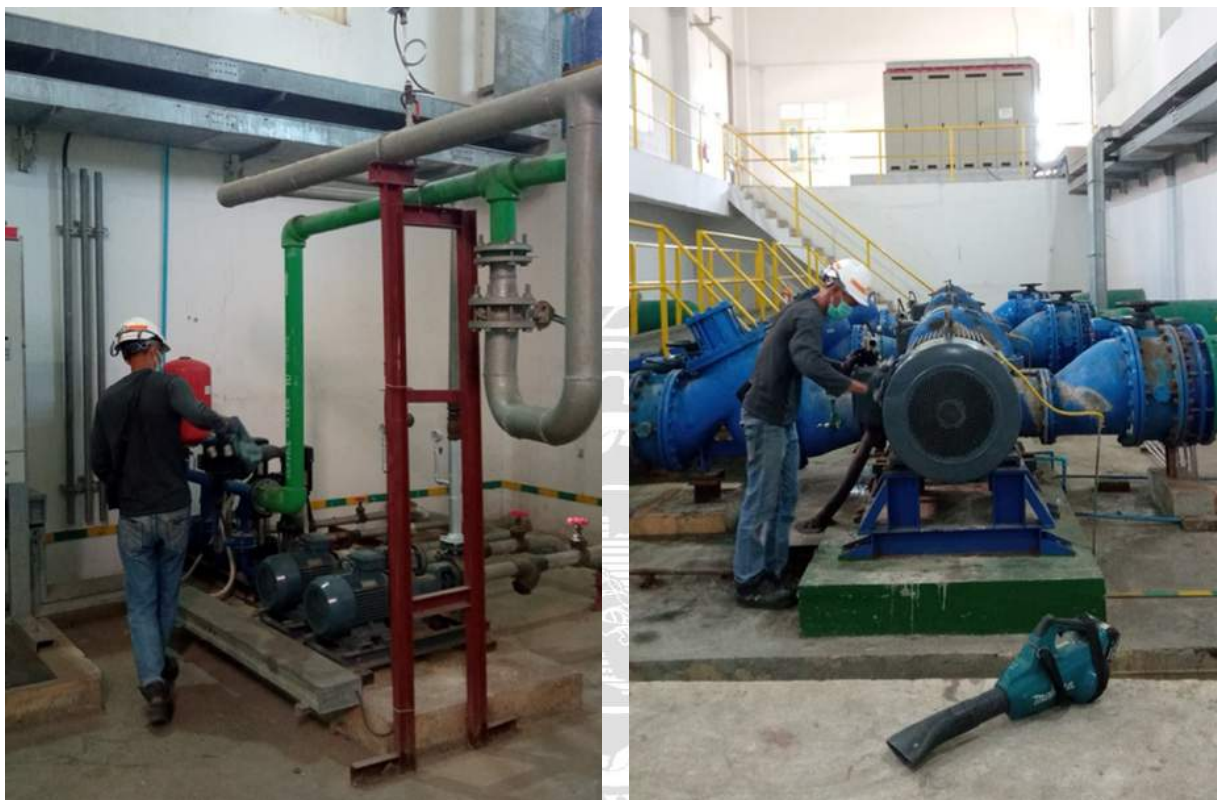
รูปที่ 4.1.15 Zone Pump House
