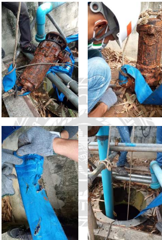
รูปที่ 4.2.6 แก้ไข Raw Pump ไม่มีแรง
