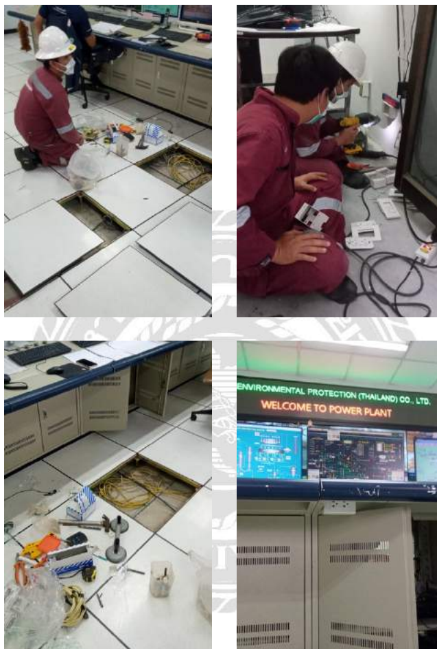
รูปที่ 4.2.4 ติดตั้งแต่เตอร์รับ DCS Room
