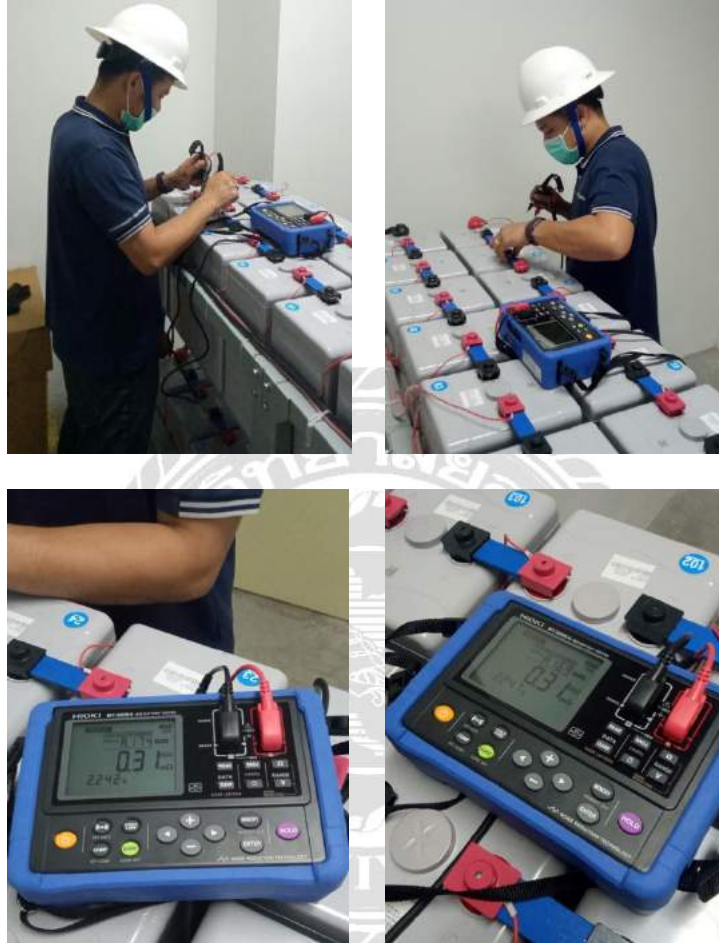
รูปที่ 4.1.10 PM PM UPS&Battery charger
