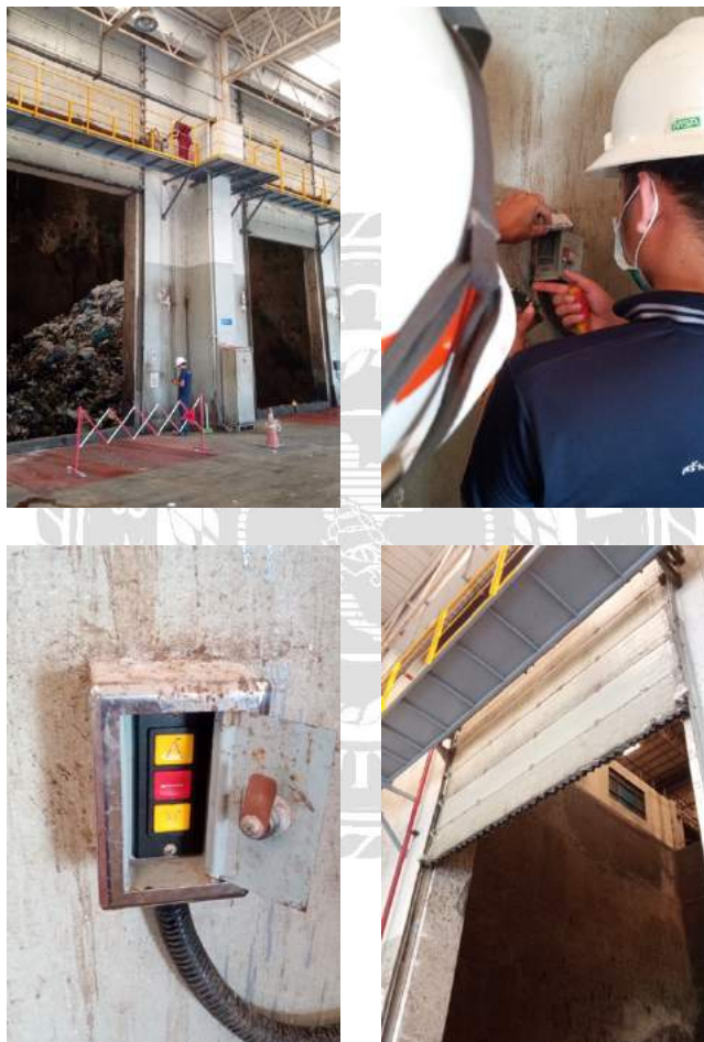
รูปที่ 4.2.1 แก้ไขประตู Dumping Zone
