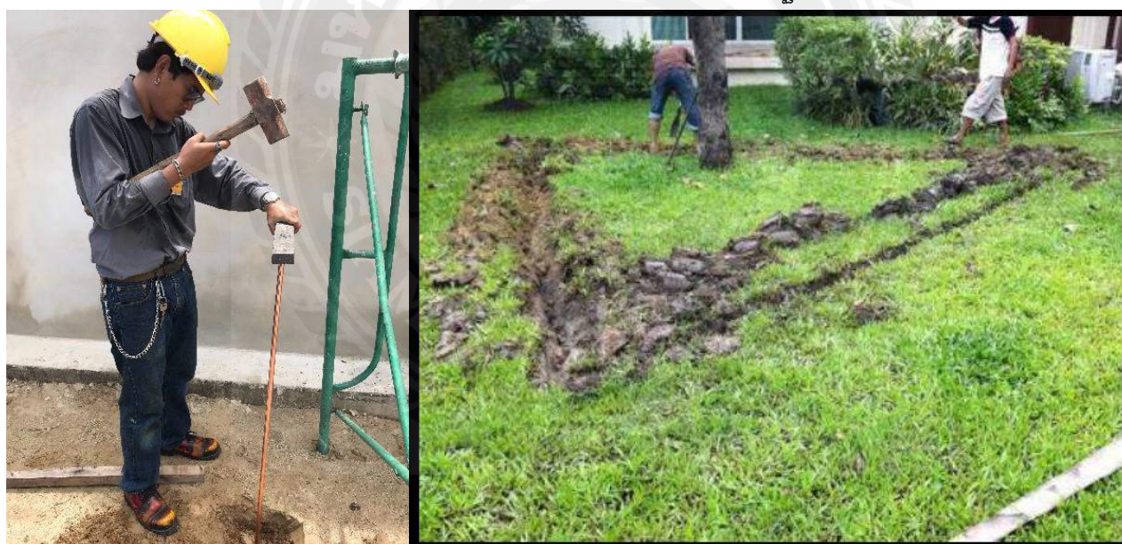
รูปที่ 4.3 ตอกแท่งกราวด์พร้อมเชื่อมกราวด์แบบ 1 Time
