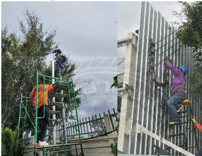
รูปที่ 4.5 ดึงสายเมนติดตั้ง Rack ลูกถ้วย ฟรีฟอร์ม จ่ายโรงงานด้านหลัง
