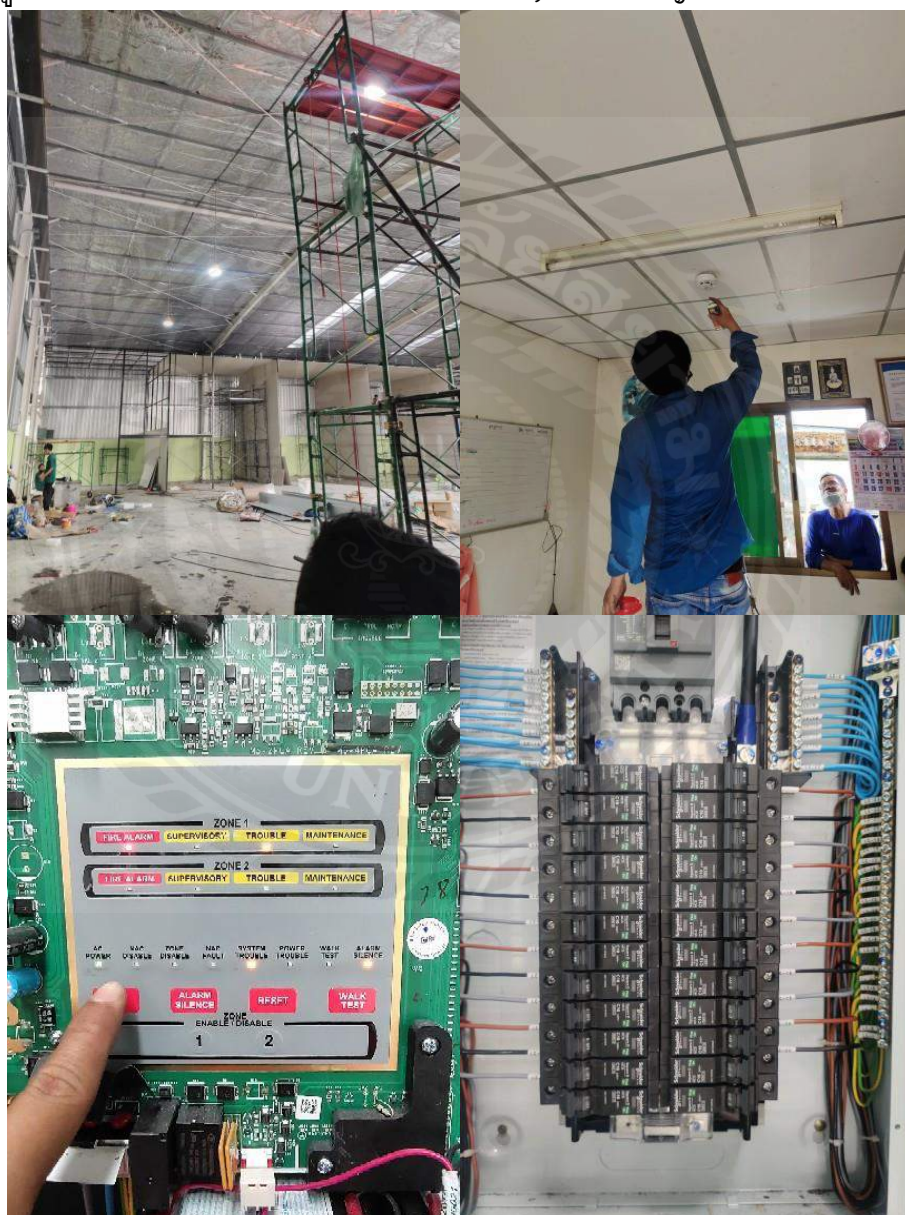
รูปที่ 4.11 เทสระบบและส่งงาน
