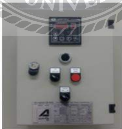
รูปที่ 2.41 ชุดควบคุมการทำงานของหม้อแปลง
