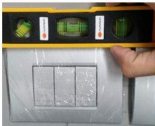
รูปที่ 4.15 การวัดระดับการติดตั้งสวิตช์ด้วยระดับน้ำ
