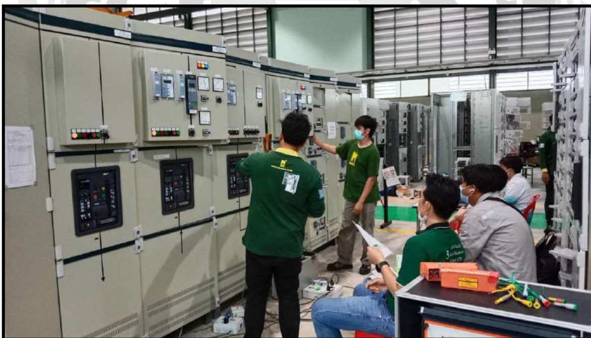
การทดสอบตู้ไฟฟ้าให้ลูกค้าดู
