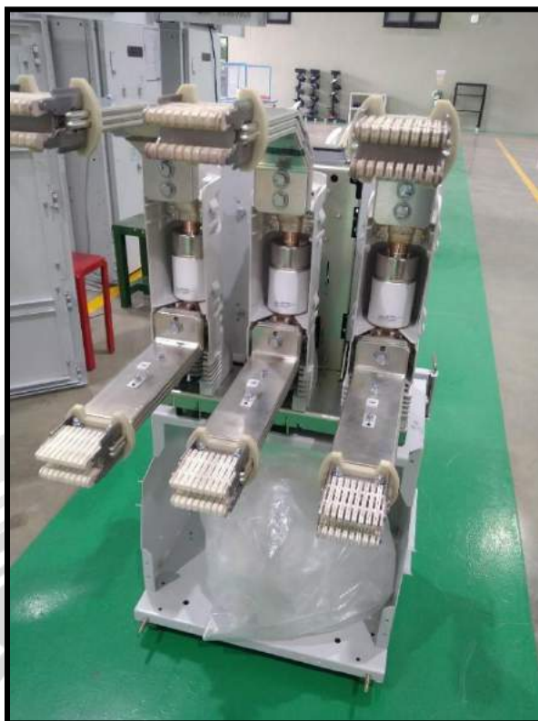
การตรวจเช็ค VCB
