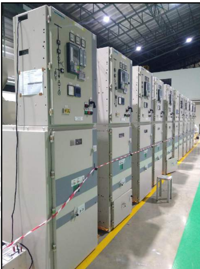
กักบริเวณที่ทำการทดสอบตู้ไฟฟ้า
