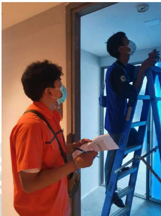
ตรวจสอบการทำงานของระบบแจ้งเหตุเพลิงไหม้
