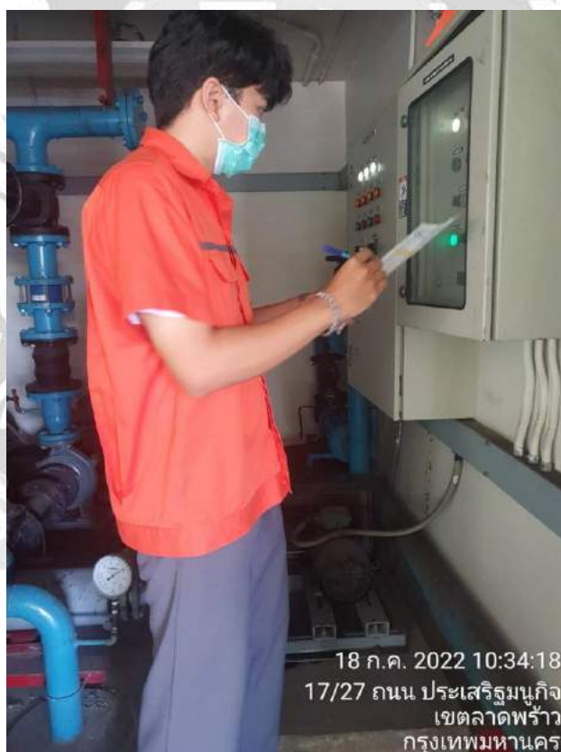
ตรวจเช็คการทำงานของปั้มน้ำดีจากตู้คอนโทรล (ประจำวัน)
