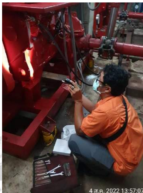
รูปที่ 4.2.2 ดำเนินการตรวจเช็ครอยรั่วซึมน้ำมันเครื่องของระบบปั้มน้ำดับเพลิง
