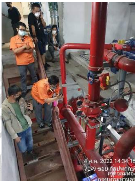
รูปที่ 4.2.6 ตรวจเช็คเกจวัดแรงดัน และทดสอบเกจวัดแรงดัน
