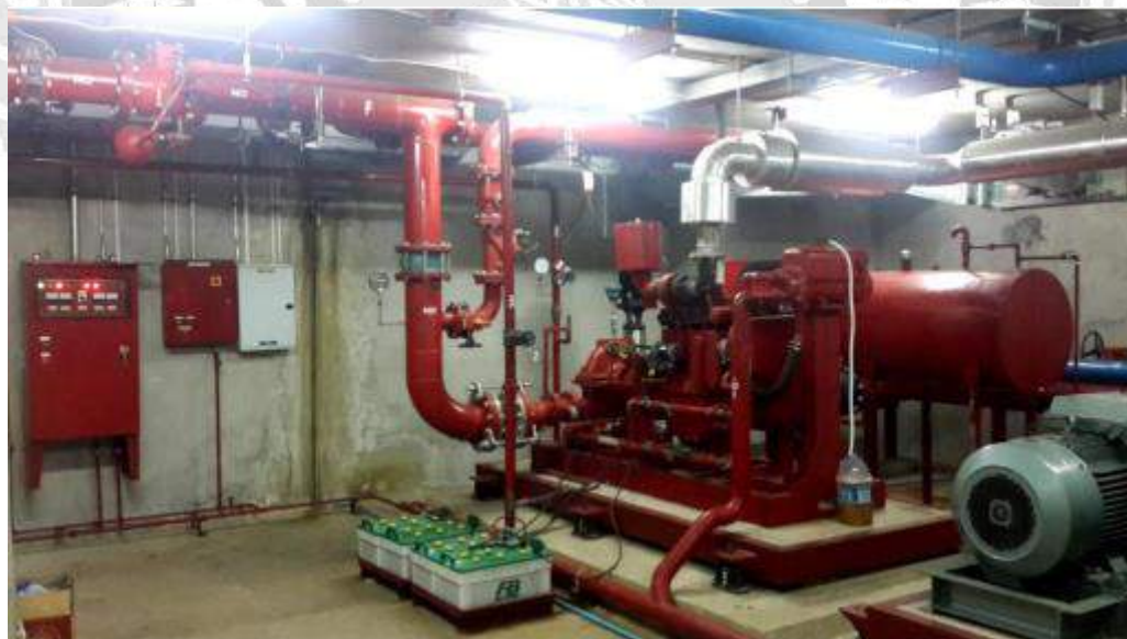
รูปที่ 2.4 ระบบเครื่องสูบน้ำดับเพลิง (Fire Pump System)
