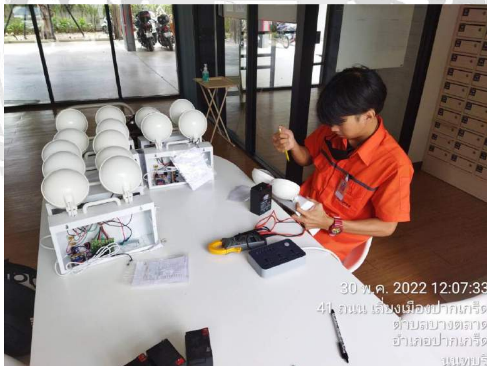
ตรวจเช็คและเปลี่ยนแบตเตอรี่ไฟฉุกเฉิน
