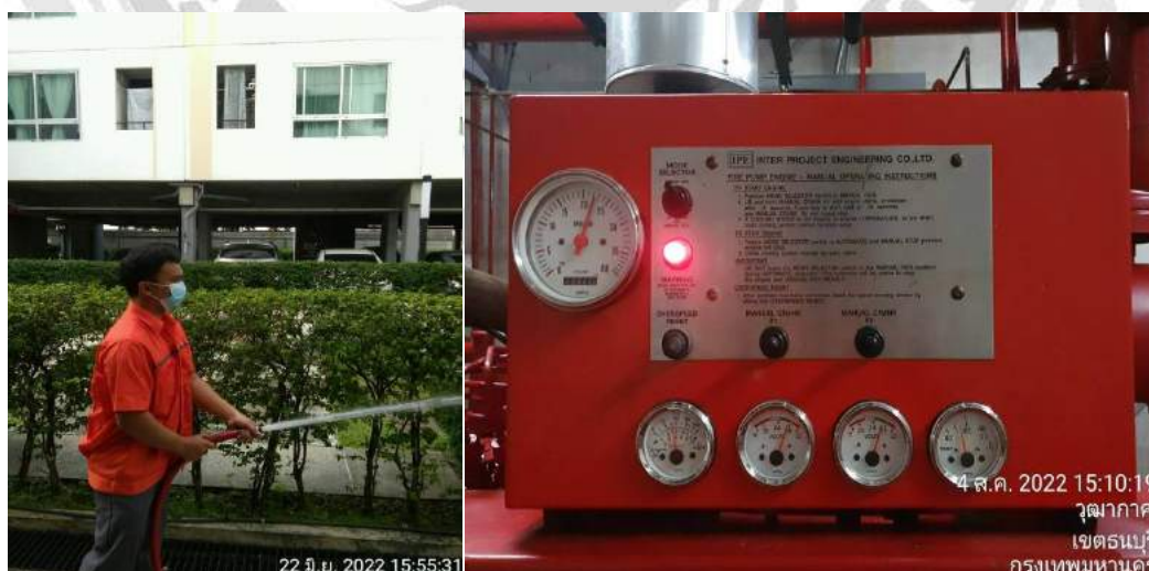
รูปที่ 4.2.7 ทดสอบการของระบบปั้มน้ำดับเพลิง
