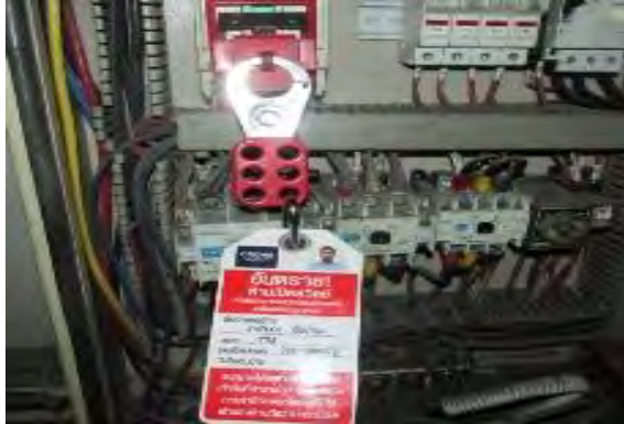
รูปที่ ข18 การติด Lock out Tag out
