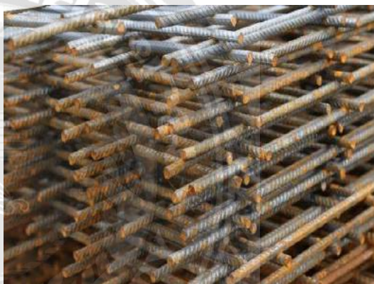
(ข) จัดเก็บวัสดุไม่เหมาะสมทำให้เสียหายใช้งานไม่ได้เมื่อต้องการใช้
