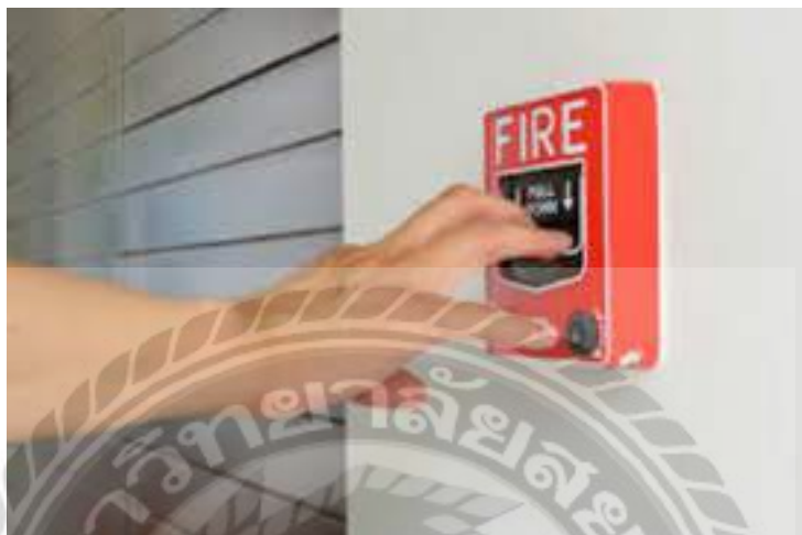
รูปที่ 4.8 ตรวจเช็ค manual fire alarm hand
