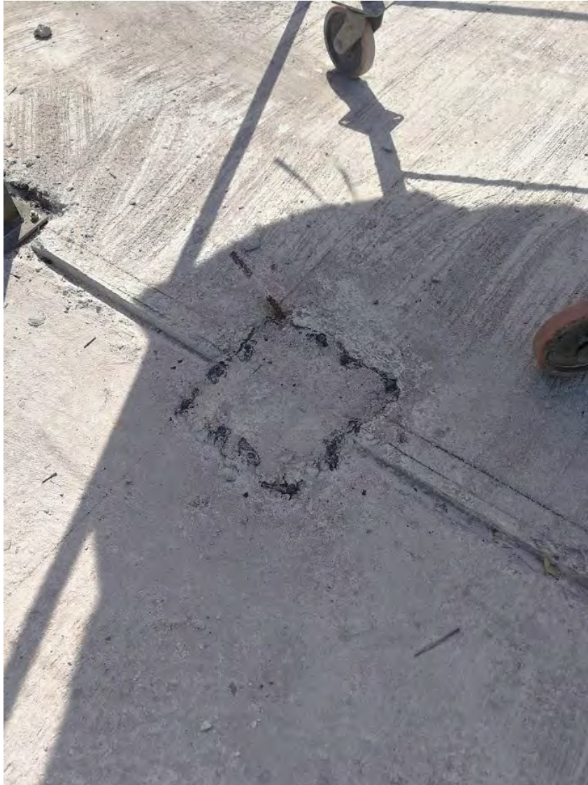
รูปที่ 4.65 รูปภาพเหล็ก Dowel ที่ถูกตัดขาด
