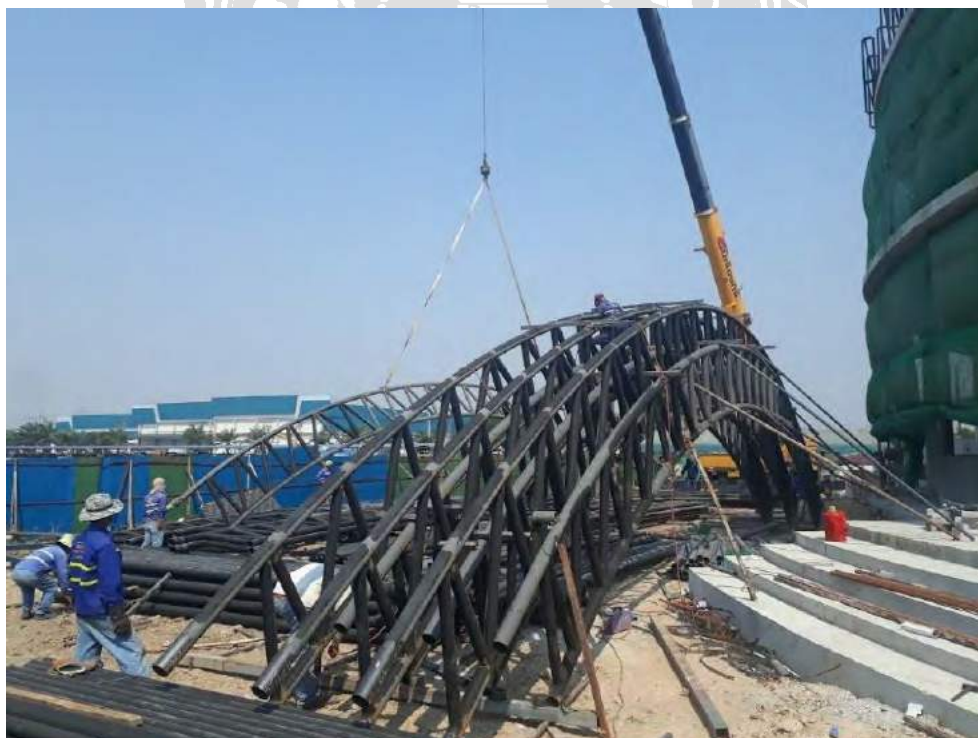
รูปที่ 4.53 ประกอบชิ้นงานโครงสร้างหลังคา T-1
