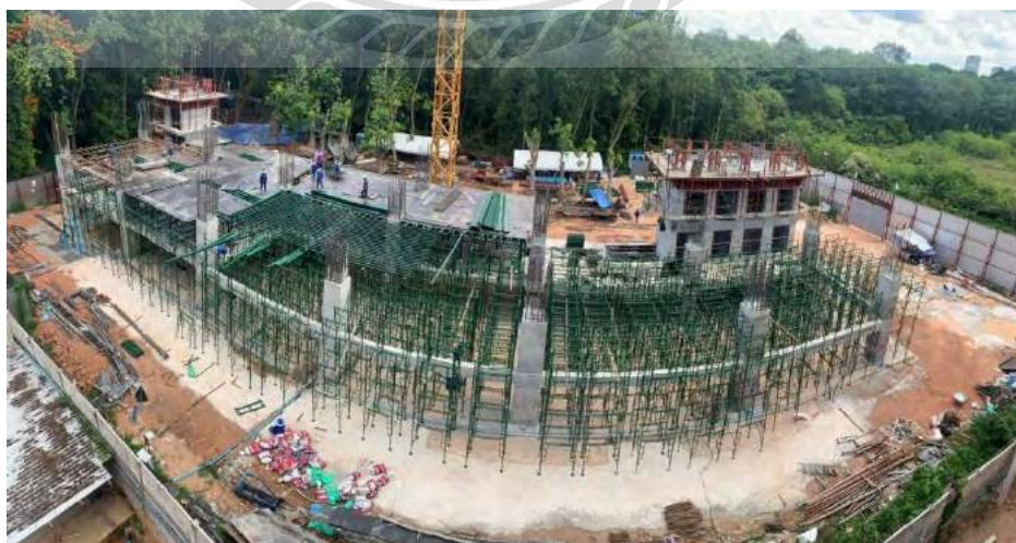
รูปที่4.6 ภาพรวมการตั่งนั่งร้านรับพื้นชั้น2
