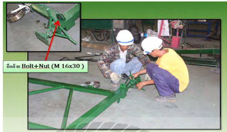
รูปที่ 3.44 ขั้นตอนที่ 1 ติดตั้ง TF-Jack เข้ากับขา TF-Frame 150 ทั้ง 2 ด้าน
