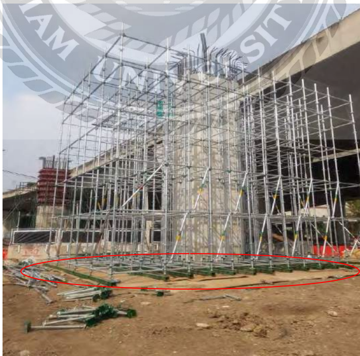
รูปที่4.20 Formwork ระบบ Ring Lock ที่ติดตั้งBase Collarผิด
