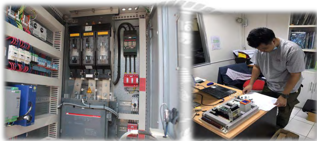
รูปที่ 4.1 ตู้ควบคุมระบบไฟฟ้าในอาคาร
