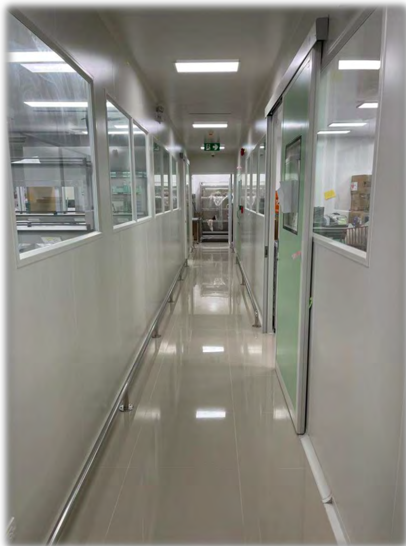
รูปที่ 4.9 ทดสอบระบบไฟส่องสว่างหลังการติดตั้ง
