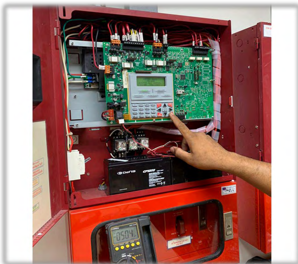
รูปที่ 4.18 ตู้ Fire Alarm
