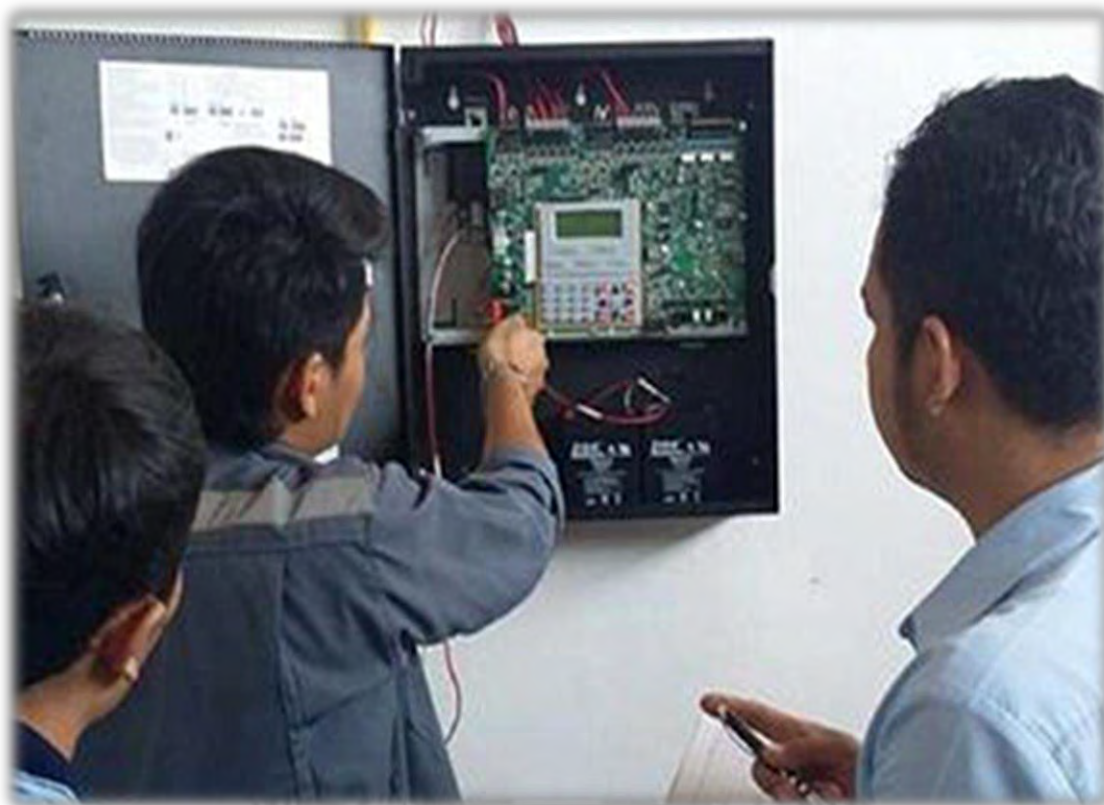
รูปที่ 4.19 ตรวจสอบระบบ Fire Alarm System หลังการติดตั้ง
