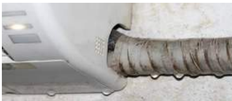
รูปที่ 4.3 การติดตั้งที่ไม่ได้มาตรฐาน
