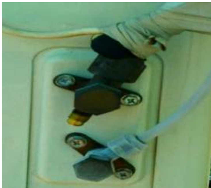
รูปที่ 4.10 แอร์เป็นน้ำแข็งบริเวณเซอร์วิสวาล์ว
