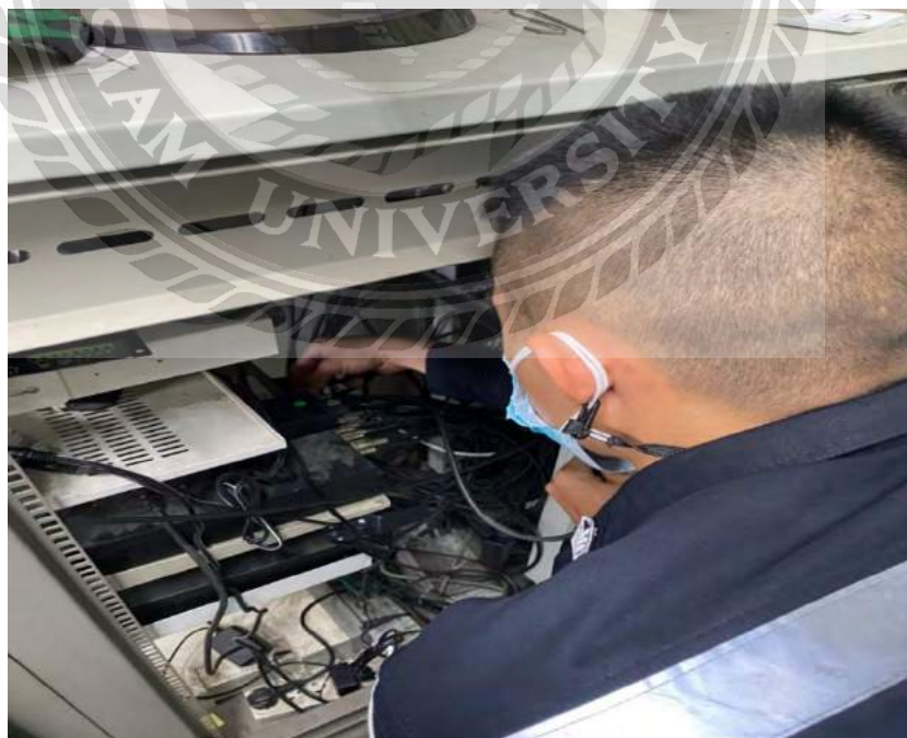
รูปที่ 4.7 ตรวจสอบ HDD ในตู้ Server
