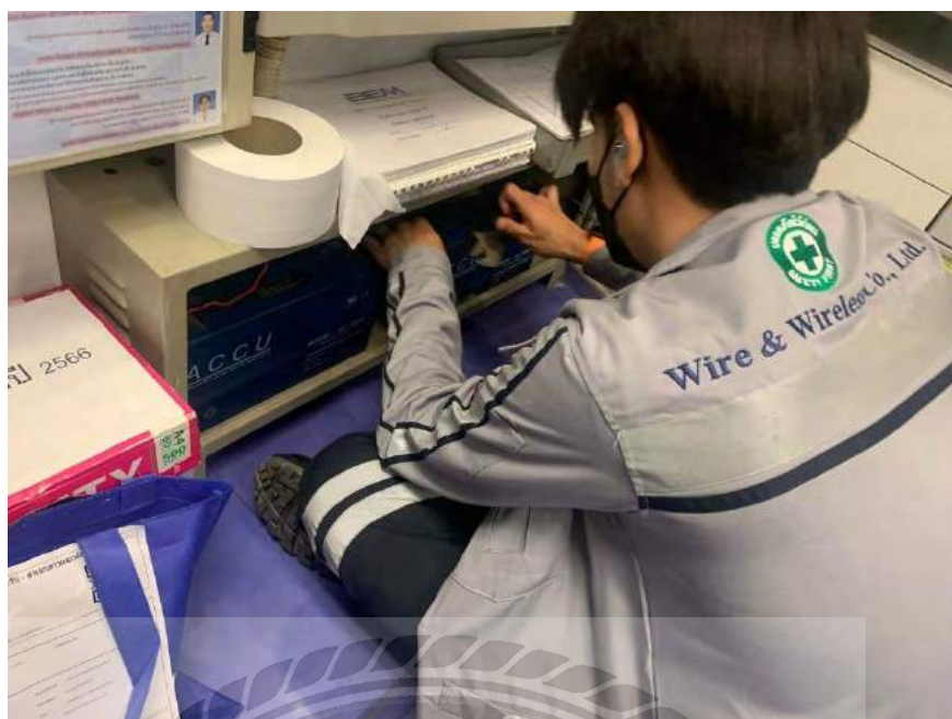
รูปที่ 4.10 ทำการเช็คสภาพแบตเตอรี่ ของตู้ FCP ไม่ให้เกิด Trouble แบตเตอรี่หรือสายแบตเตอรี่ หลุดหลวม
