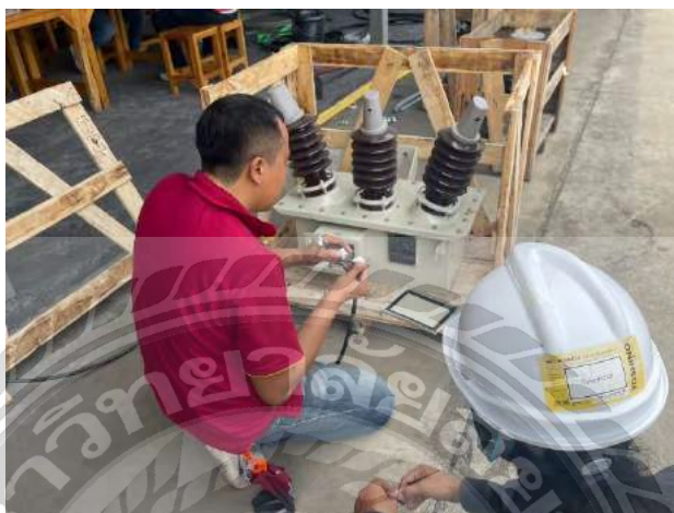
รูปที่ 4.18 เช้าสาย PT หม้อแปลงแรงดันไฟฟ้า
