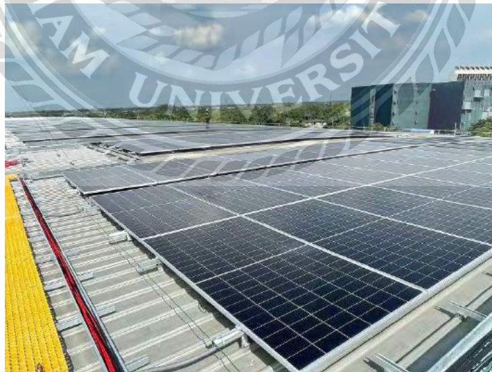
รูปที่ 4.13 ติดตั้งแผงโซล่าเซลล์แล้วเสร็จ
