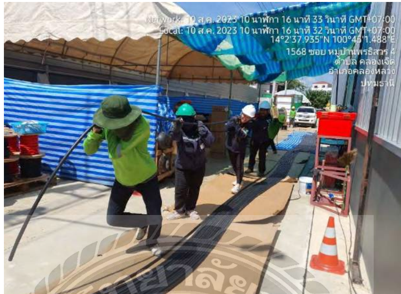
รูปที่ 8 AC Cable Wiring
