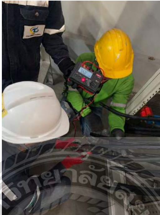
รูปที่ 10 Insulation AC Cable
