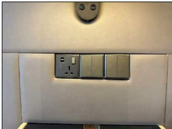
รูปที่ 4.13 ปลั๊กและสวิตช์บริเวณหัวเตียง ห้อง Type 2B1 เป็นสวิตช์สำหรับโคมไฟหัวเตียงภายในห้องนอน เป็นสวิตช์ที่แยกการทำงานระหว่างโคมไฟซ้าย-ขวาของบริเวณหัวเตียง
