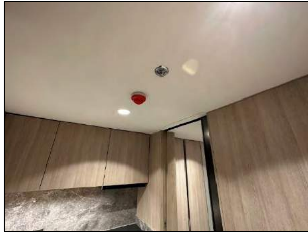
รูปที่ 4.21 ห้องครัว Type 2B1 ระบบแสงสว่างประกอบด้วยโคมไฟชนิด AJ1 รวมถึงระบบฉุกเฉินภายในห้องครัว ประกอบด้วย Smoke, Sprinkler Head and Heat Detector
