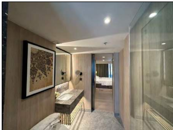
รูปที่ 4.15 บริเวณห้องน้ำห้อง Type 2B1 ประกอบด้วยคอมไฟชนิด AJ3 และระบบฉุกเฉินภายในห้องน้ำ ประกอบด้วย Smoke, Sprinkler Head and Heat Detector
