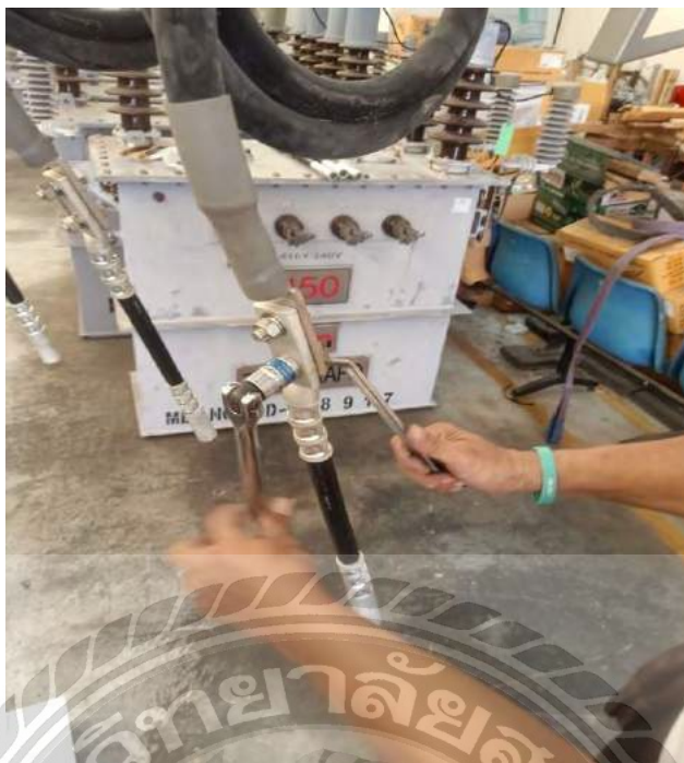
ประกอบทางปลาเข้ากับอุปกรณ์สำหรับตัดต่อระบบไฟฟ้าแรงสูง (Load Break Switch)
