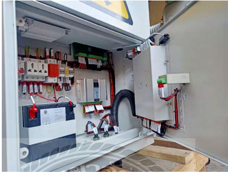
ชุด control ของตู้ FRTU (Feeder Remote Terminal Unit)
