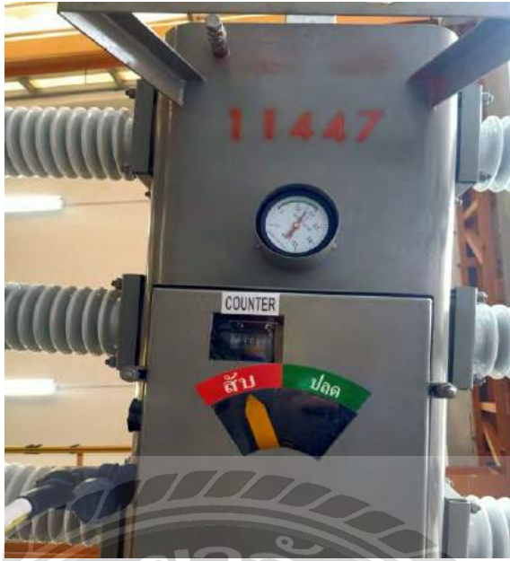
รูปที่ 4.4 จุดแสดงสถานะต่าง ๆ ของอุปกรณ์สำหรับตัดต่อระบบไฟฟ้าแรงสูง (Load Break Switch)
