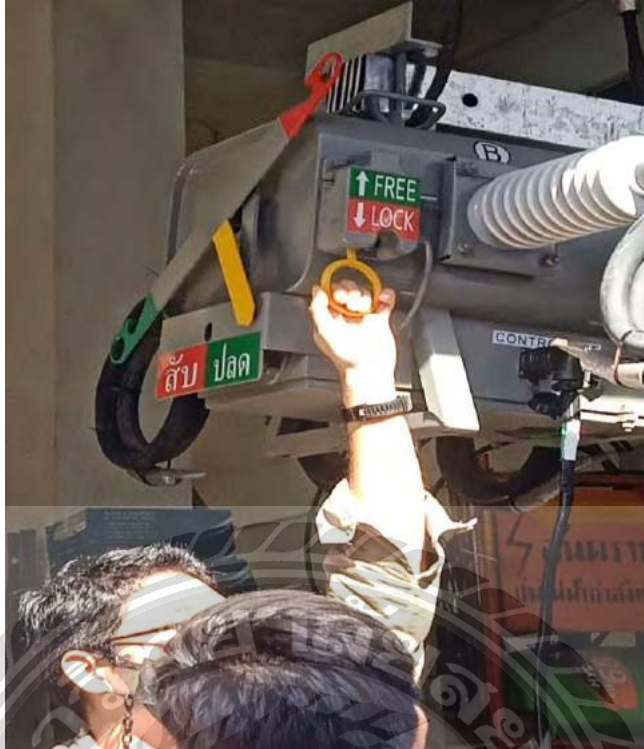
รูปที่ 4.6 จุด Safety การสับ-ปลด ของอุปกรณ์สำหรับตัดต่อระบบไฟฟ้าแรงสูง (Load Break Switch)
