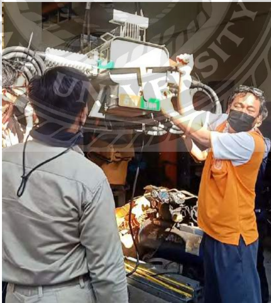
รูปที่ 4.5 วิธีการสับ-ปลด อุปกรณ์สำหรับตัดต่อระบบไฟฟ้าแรงสูง (Load Break Switch) ด้วย Manual
