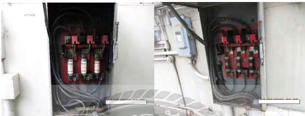
รูปที่ 4.14 ขนาดของฟิวส์และขนาดของสายไม่สอดคล้องตามมาตรฐานการติดตั้งทางไฟฟ้าของ วสท.
