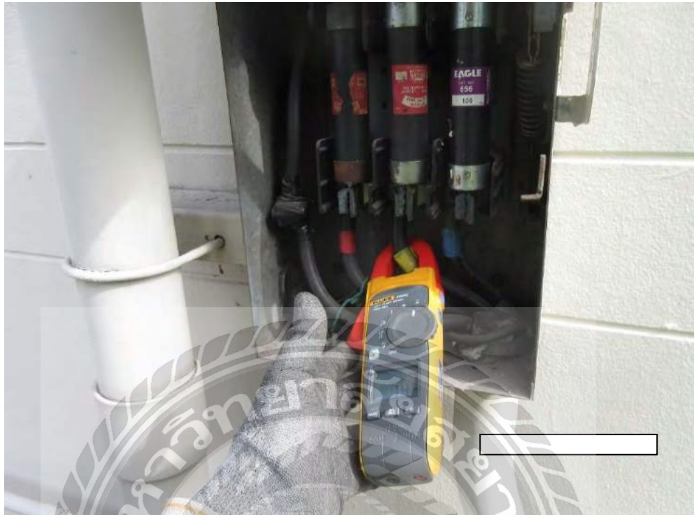
ภาพการวัดแรงดันของตู้ Disconnecting switch
