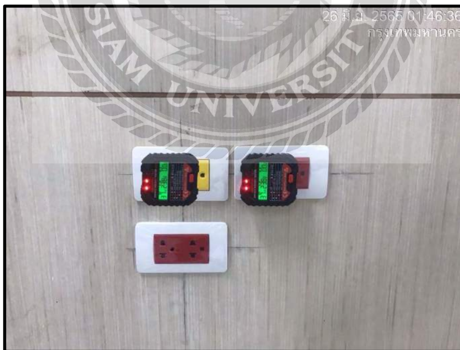
รูปที่ 4.21 ตรวจสอบแรงดันไฟฟ้าที่ OUTLET
