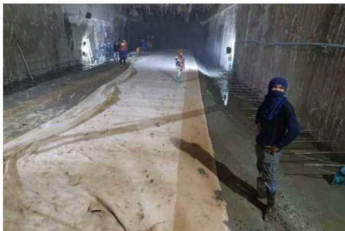
ภาพที่ 4-28 เสริมวัสดุกันซึม ช่วง TUNNEL
