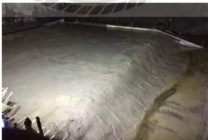
ภาพที่ 4-27 เทคอนกรีตหยาบ ช่วง TUNNEL (2)
