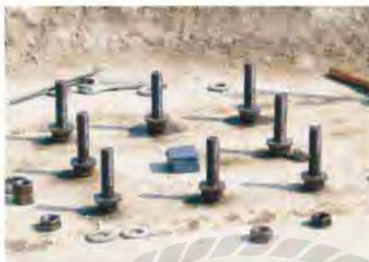
รูป 6 รูปการเตรียมงานจุดเชื่อมต่อพร้อม ANCHOR BOLT หรือ J-BOLT เชื่อมต่อกับเสาสำเร็จรูป
