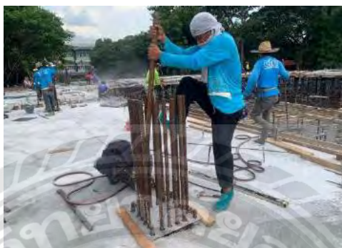
รูปที่ 4.49 การเตรียมเหล็ก Dowel เสาด้านล่างก่อนติดตั้งเสาด้านบน
