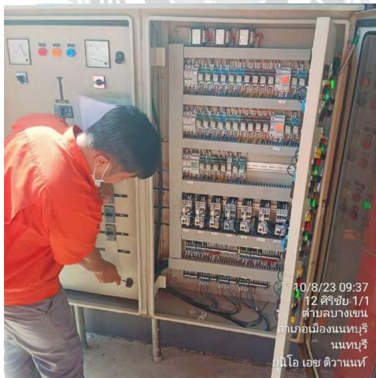
รูปที่ 10 สังเกตสุขภาพโดยรวมของตู้ควบคุมบ่อบำบัด
