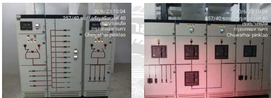
รูปที่ 2.2 ตู้ Main Distribution Board ภายในอาคาร
