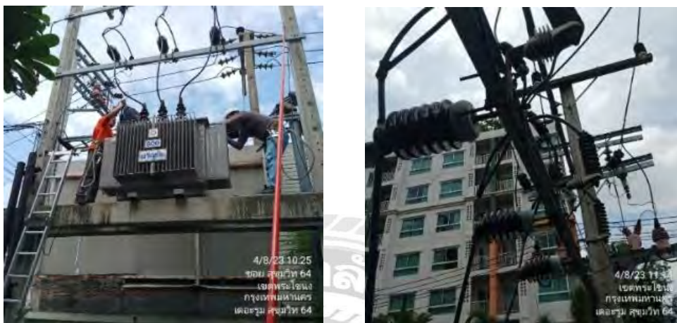
รูปที่ 2.1 หม้อแปลงไฟฟ้าภายนอกอาคาร
