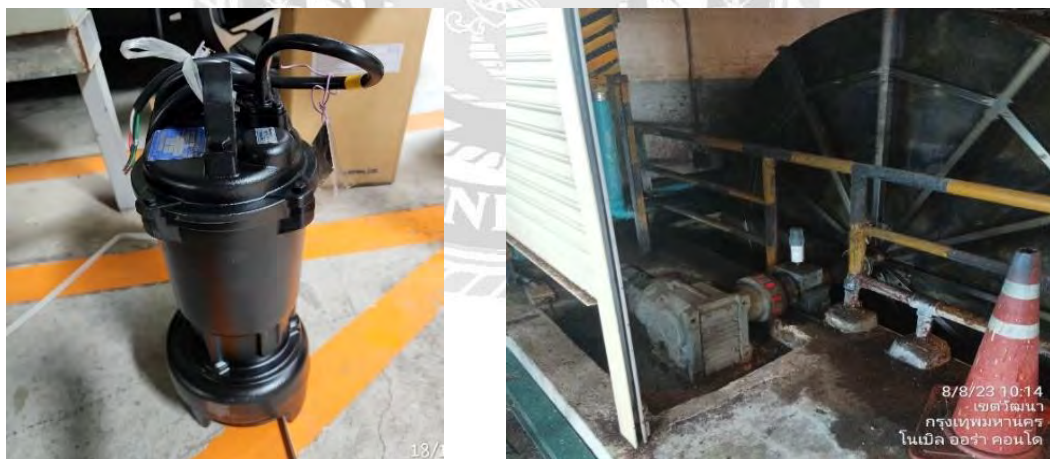
รูปที่ 2.14 ปั๊มและกังหันเติมอากาศของระบบบำบัดน้ำเสีย
