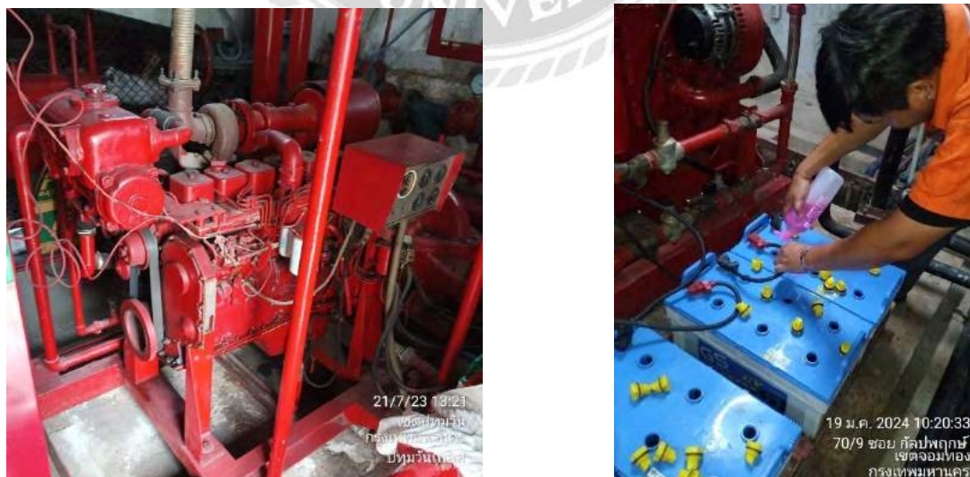
รูปที่ 4.7 การตรวจเช็คระบบป้องกันอัคคีภัย
