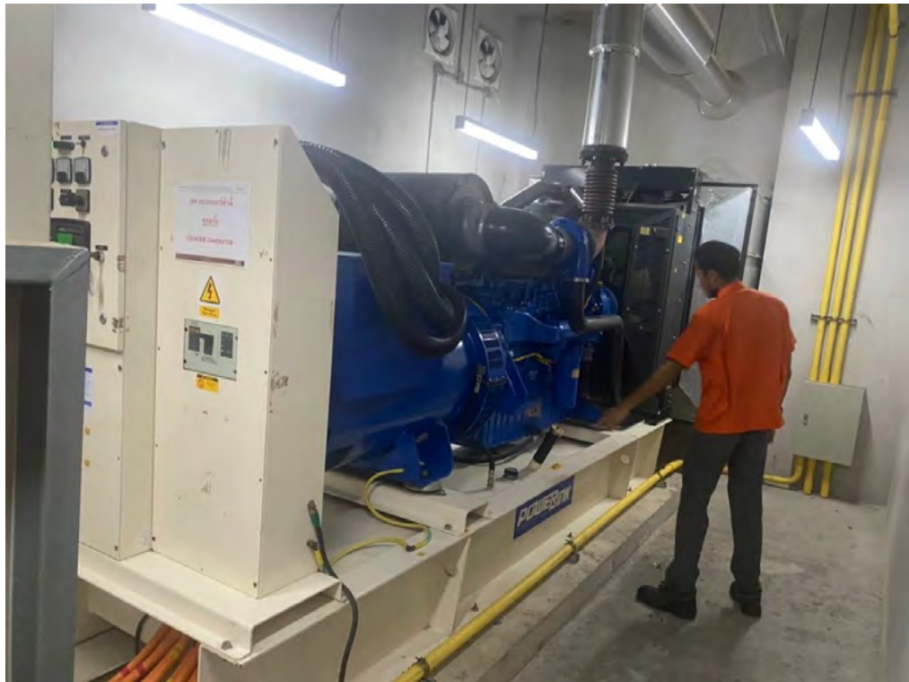
รูปที่ 3 สังกะตระดับน้ำมันของเครื่อง Generator
