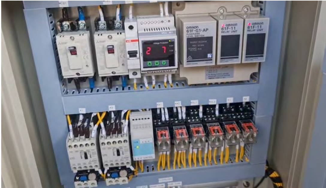
รูปที่ 11 สังกะสี Digital Meter, เฟสโปรเทคชั่น, เบรกเกอร์ในตู้ควบคุม
