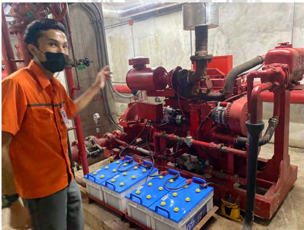
รูปที่ 6 เทสการทำงานของ Fire Pump
