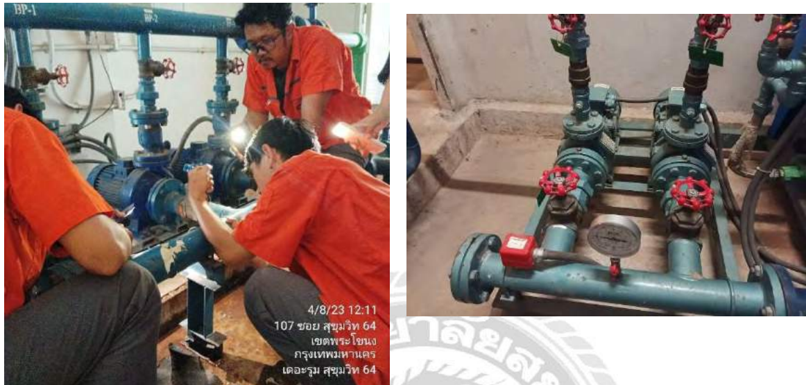
รูปที่ 4.6 การตรวจเช็คระบบปั้มน้ำเพิ่มแรงดัน
