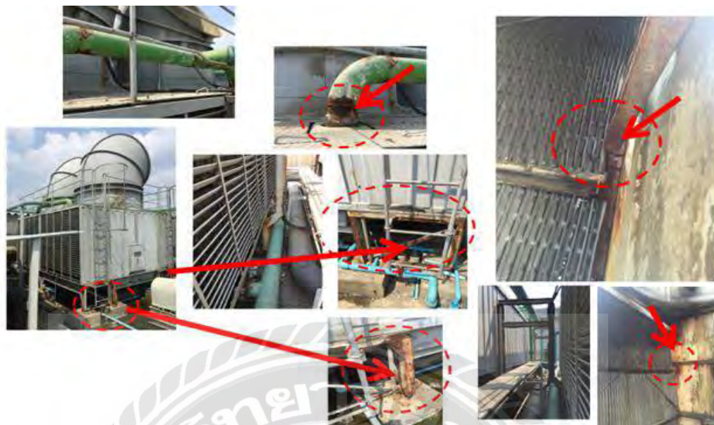
รูปที่ 4. 4 แสดงปัญหา COOLING TOWER No.14 ก่อนทำการปรับปรุง
