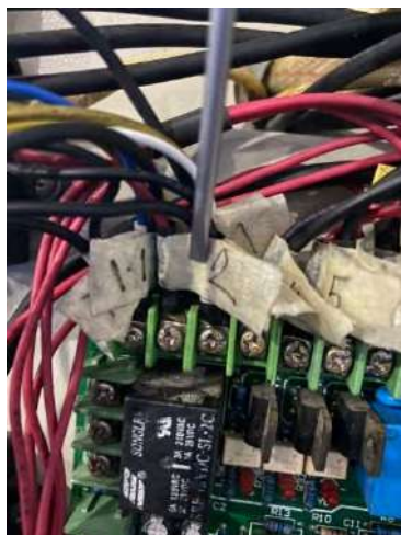
รูปที่ 4.7 ทำมาสดจุดที่ 2 ในบอร์ดควบคุม
