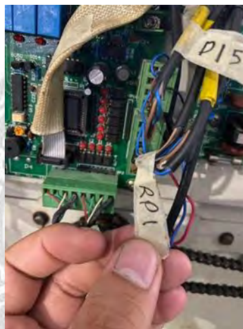
รูปที่ 4.23 ทำมาสดจุดที่ PRI ในบอร์ดควบคุม
