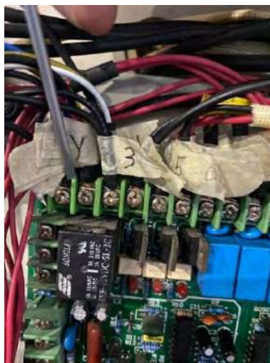
รูปที่ 4.9 ทำมาสดจุดที่ 3 ในบอร์ดควบคุม
