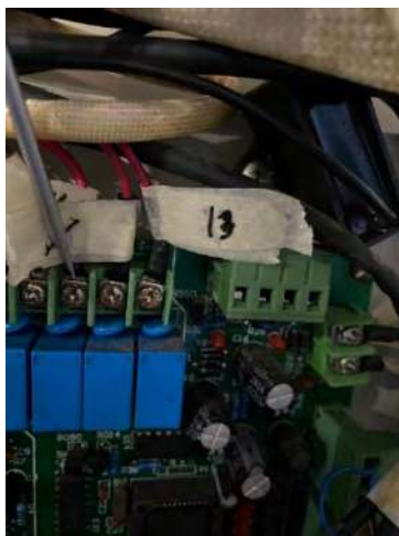
รูปที่ 4.19 ทำมาสดจุดที่ 13 ในบอร์ดควบคุม
