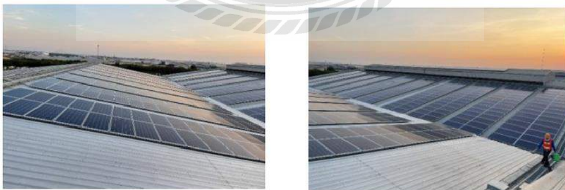
รูปที่ 3.4 ตำแหน่งที่ติดตั้งแผงโซลาร์เซลล์บนหลังคา
