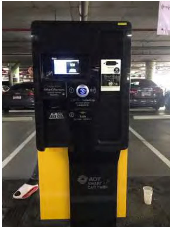
รูปที่ 4.11 ติดตั้ง ตู้จ่ายบัตรอัตโนมัติ
