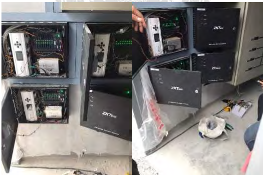
รูปที่ 4.14 ติดตั้งบอร์ดควบคุมลิฟท์
