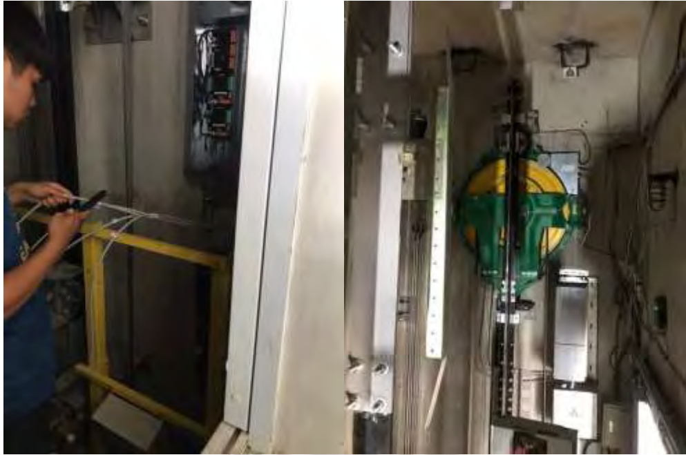
รูปที่ 4.15 เดินสายสัญญาณจากบอร์ดควบคุมเข้าลิฟท์
