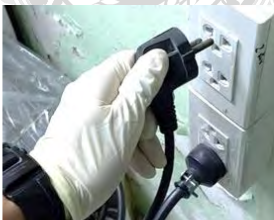
รูปที่ 4.25 ถอดปลั๊กออกหลังเลิกใช้งาน
