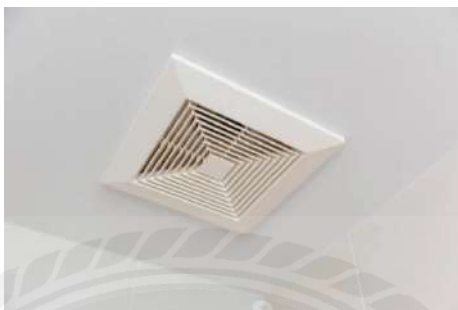
รูปที่ 2.4 พัดลมดูดอากาศ
