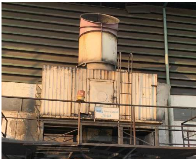
รูปภาคผนวกที่ 7 Cooling Tower ของเครื่องจักร TU-502
