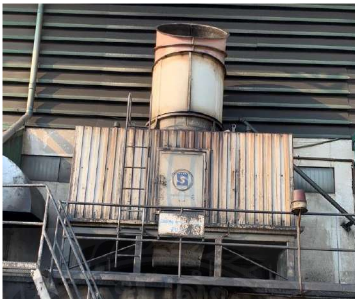
รูปภาพผนวกที่ 9 Cooling Tower ของเครื่องจักร TU-954
