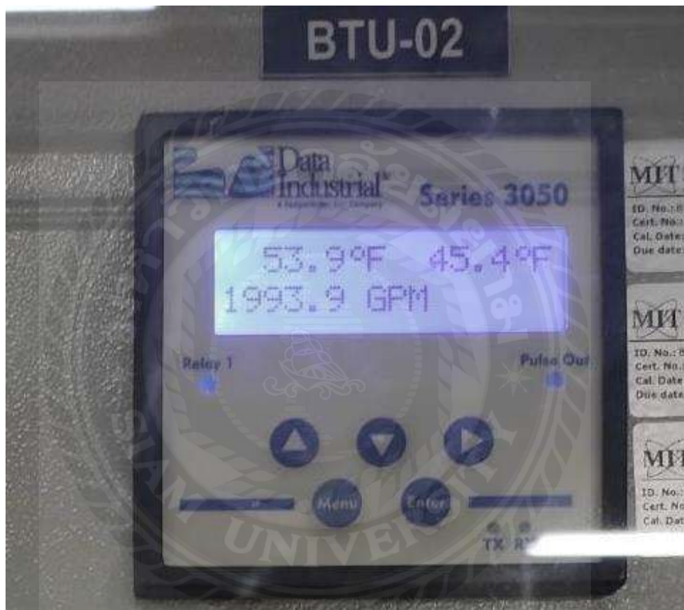
รูปที่ 3.23 ตรวจสอบค่าอัตราการไหลของน้ำเย็นที่ผ่าน Chiller
