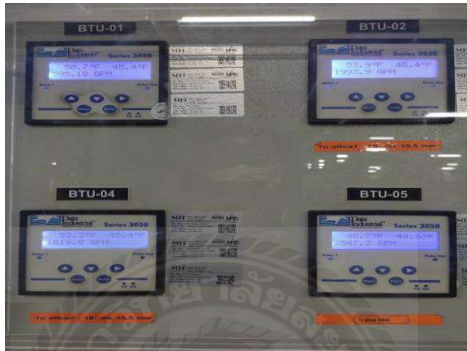
รูปภาพผนวก ที่ 9 ตรวจสอบค่าอัตราการไหล Chiller
