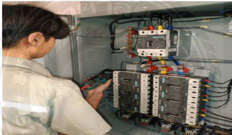
รูปที่ 3.18 ตรวจสอบตู้ควบคุม
