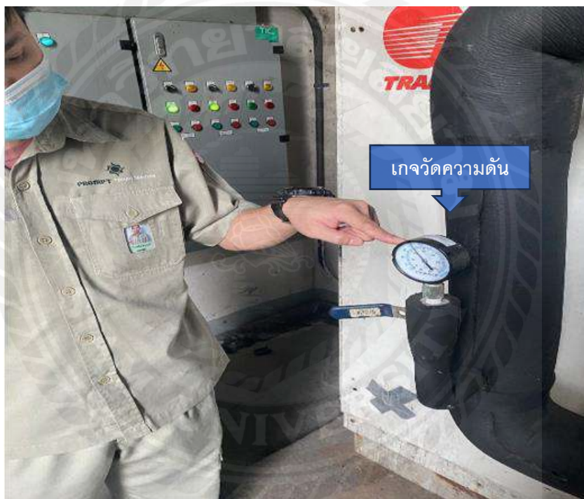
รูปที่ 3.20 ตรวจสอบเกจวัดความดัน
