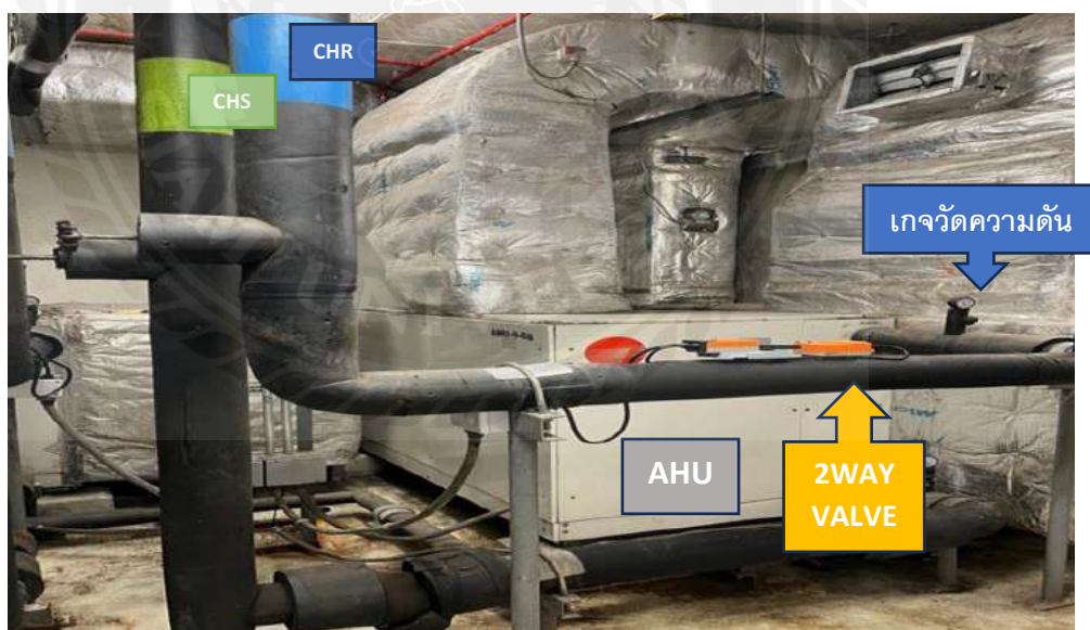
รูปที่ 3.8 สภาพห้องเครื่อง AHU
