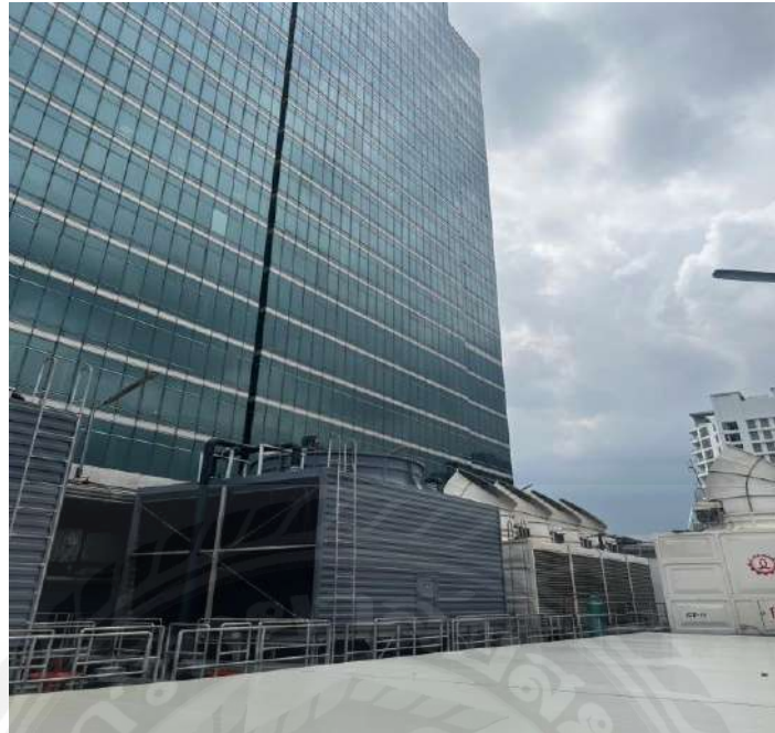
รูปภาพผนวก ที่ 3 สถานที่ตั้ง Cooling Tower
