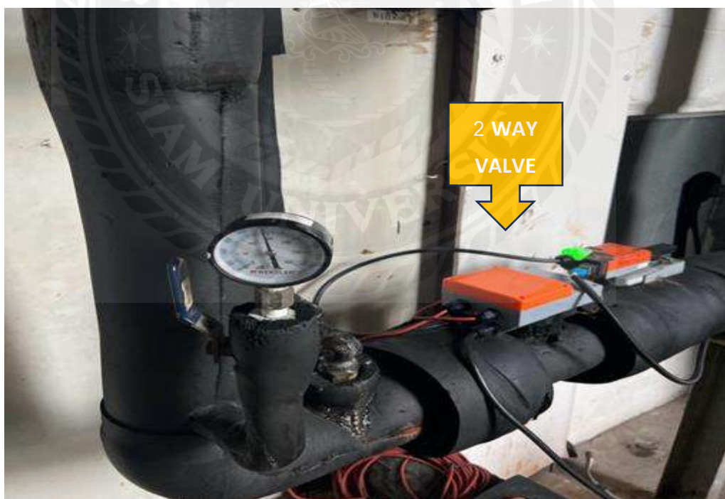
รูปที่ 3.21 การตรวจสอบอุปกรณ์ ทูเวย์วาล์ว (2 way valve)
