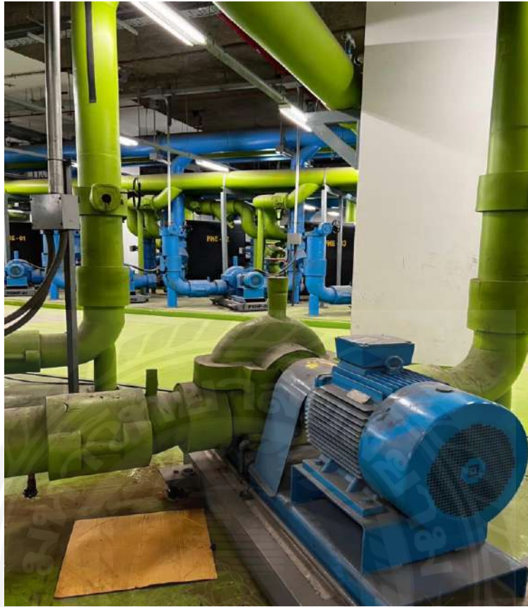
รูปภาพผนวก ที่ 5 บริเวณ Chill Pump
