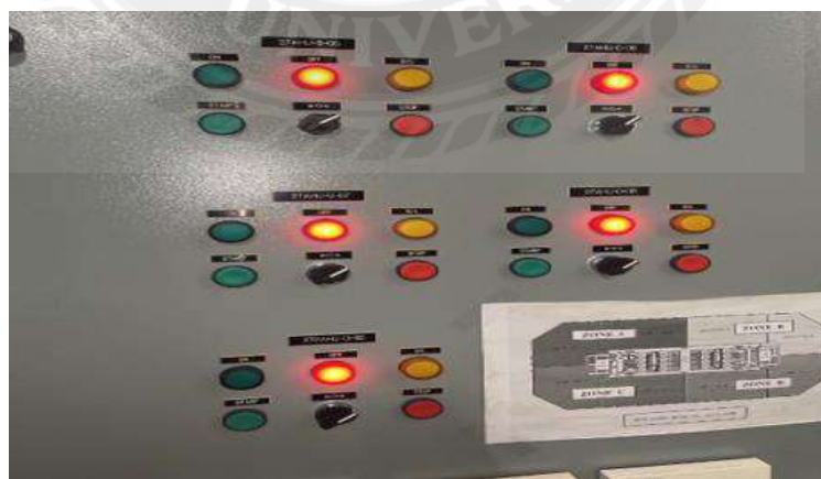
รูปที่ 3.19 ไฟหน้าตู้ควบคุม
