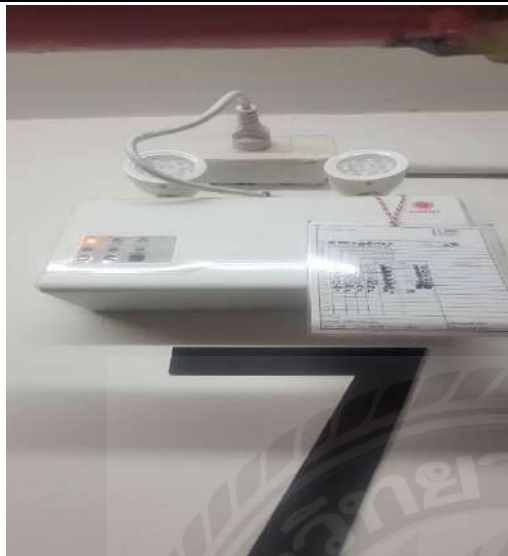
รูปภาคผนวก ที่ 39 มีแบตเตอรี่สำรองในไฟป้าย
