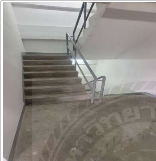
รูปภาคผนวก ที่ 1 บันไดฝั่งที่ 1 ไม่มีสิ่งกีดขวาง
