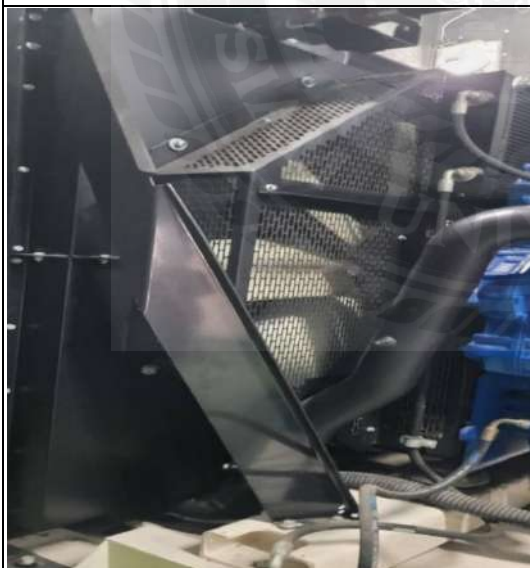
รูปภาคผนวก ที่ 51 ระบบระบายอากาศของเครื่องยนต์ขณะทำงาน งานมีการระบายอากาศได้ปกติ
