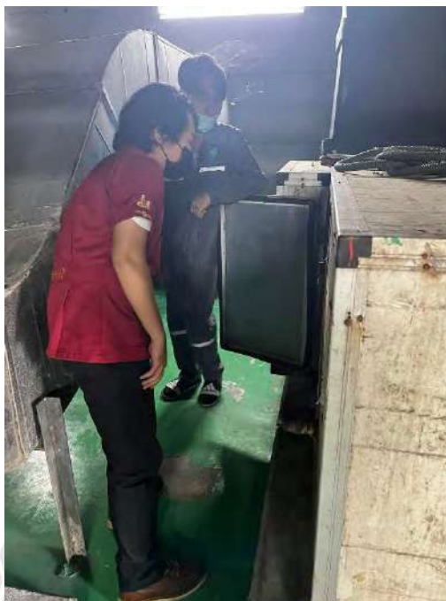
รูปที่ 4.2.4 ดำเนินการตรวจสอบภายในตู้ Fresh Air Unit (AFU)
