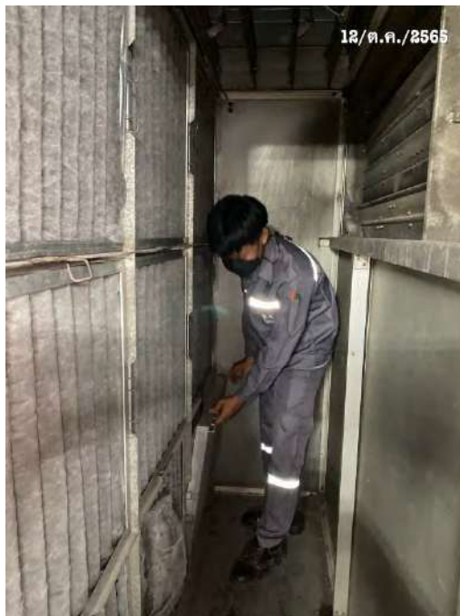
รูปที่ 4.2.6 ดำเนินการตรวจสอบฟิวเตอร์กรองอากาศ
