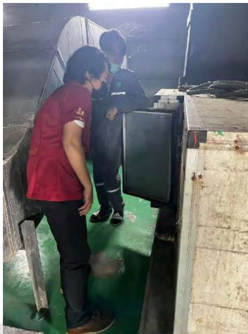
ดำเนินการตรวจสอบภายในตู้ Fresh Air Unit (AFU)
