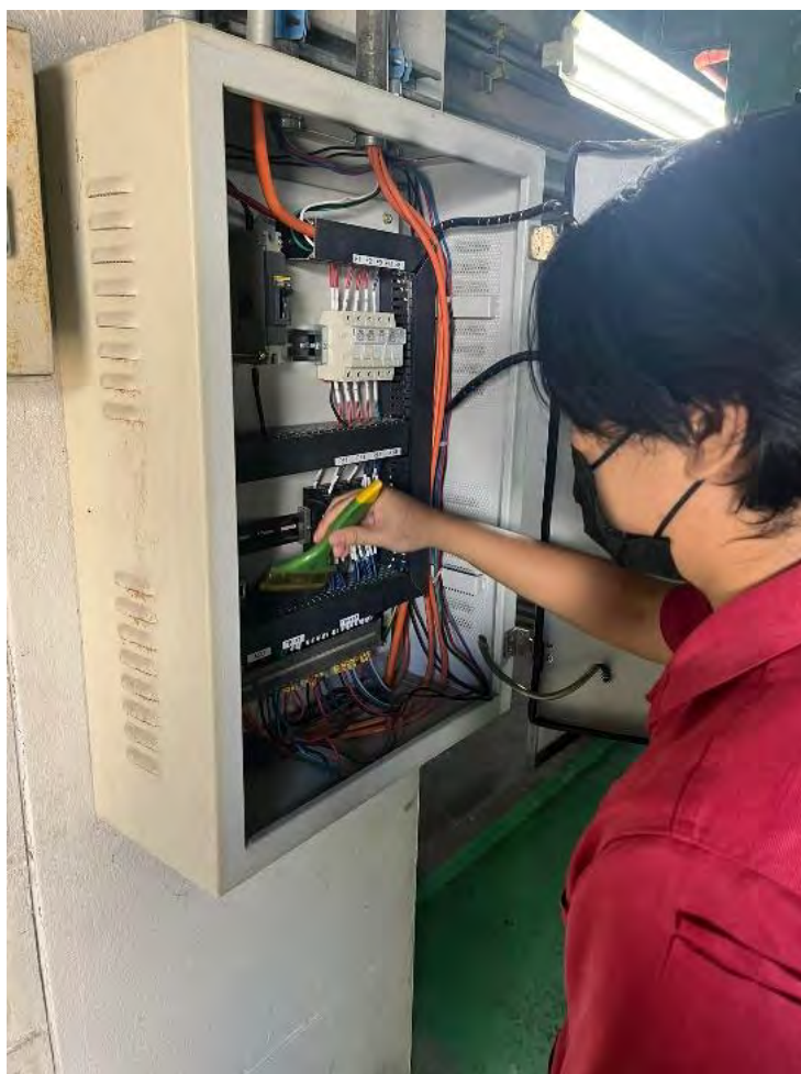
ทำความสะอาดภายในตู้ควบคุมในส่วนของเทอร์มินอลบล็อก
