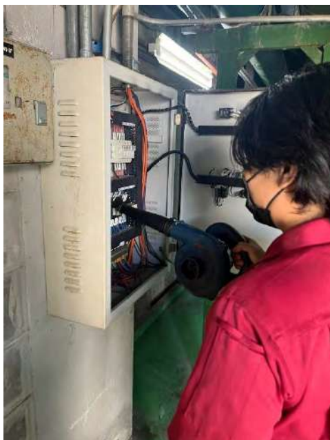
ทำความสะอาดเป่าฝุ่นที่อยู่ภายในตู้
