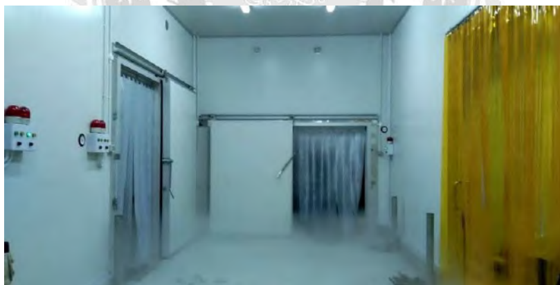
รูปที่ 2.17 ห้องเย็น
