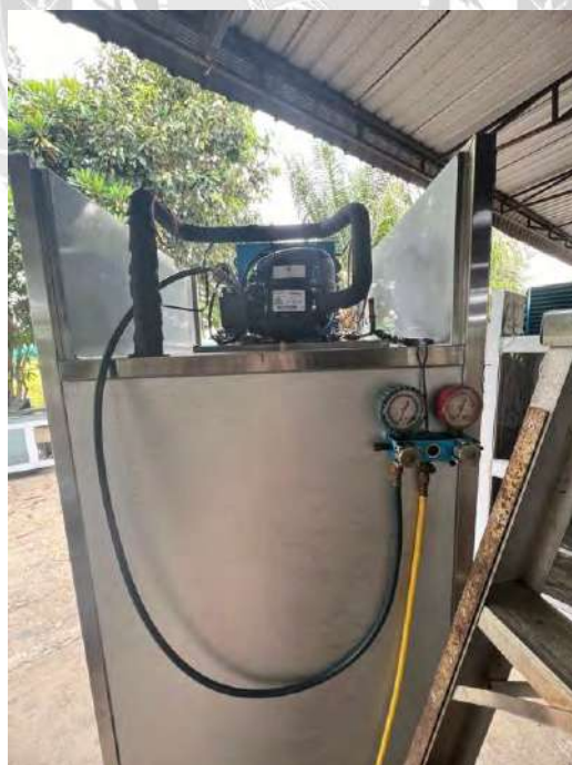
รูปที่ 4.15 การเติมสารทำความเย็นเข้าระบบทำความเย็น
