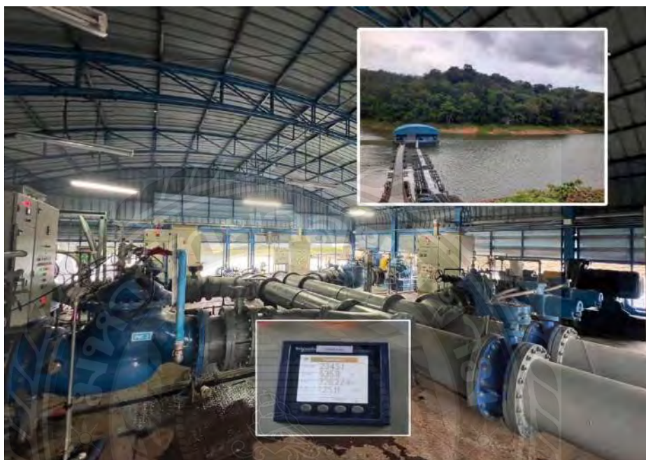
รูปที่ 4.1 เครื่องสูบน้ำดิบและระดับน้ำอ่างบางวาด
