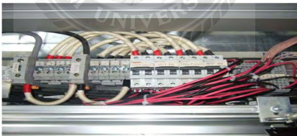
รูปที่ 2.61 เซอร์กิตเบรกเกอร์ของกล่องอุปกรณ์จ่ายไฟฟ้ากระแสตรง
