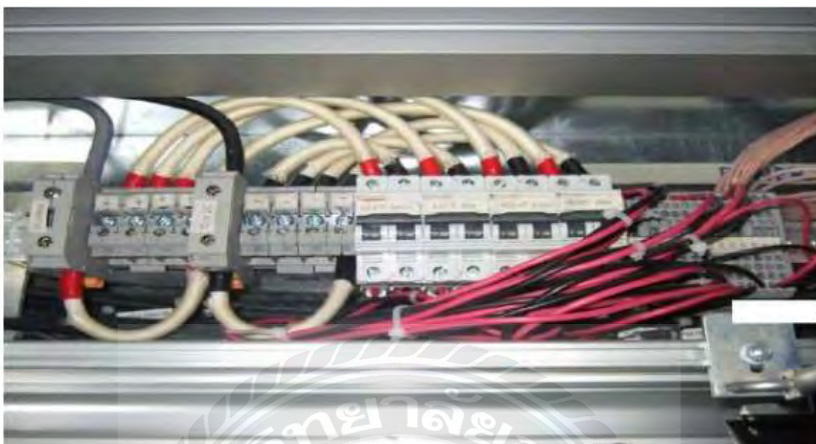
รูปที่ 2.23 ชุดควบคุมการติดต่อสื่อสารระบบประตูกั้นขนชาลา
