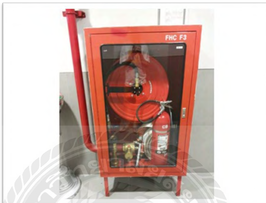
รูปที่ 2.29 ภาพแสดงตู้ฉีดน้ำดับเพลิง (Fire Hose Cabinet)
