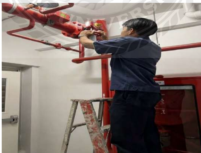
รูปที่ 4.19 อุปกรณ์ตรวจสอบสถานะของวาล์วน้ำ ( Supervisory Switch)
