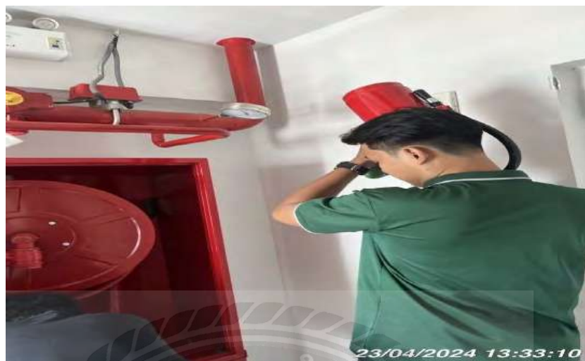
รูปที่ 4.22 ตรวจเช็คตู้ Fire Houst และ ถังดับเพลิง ประจำเดือน
