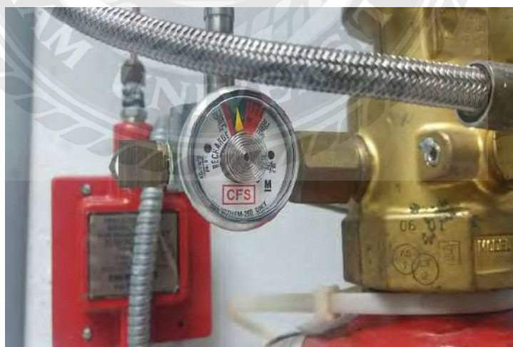
รูปที่ 2.22 ระบบดับเพลิงอัตโนมัติด้วยสารสะอาด FM-200 (สถานะอยู่ในตำแหน่งปกติ)
