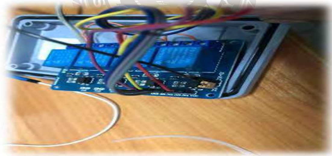
รูปที่ 4.10 อุปกรณ์ไฟฟ้าที่เชื่อมต่อกับ Relay จะทำงานตาม Relay
