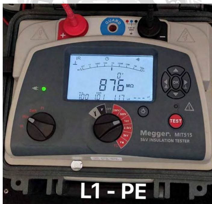
รูปที่ 7 ทดสอบค่าความเป็นฉนวนในระบบของตู้ไฟฟ้า
