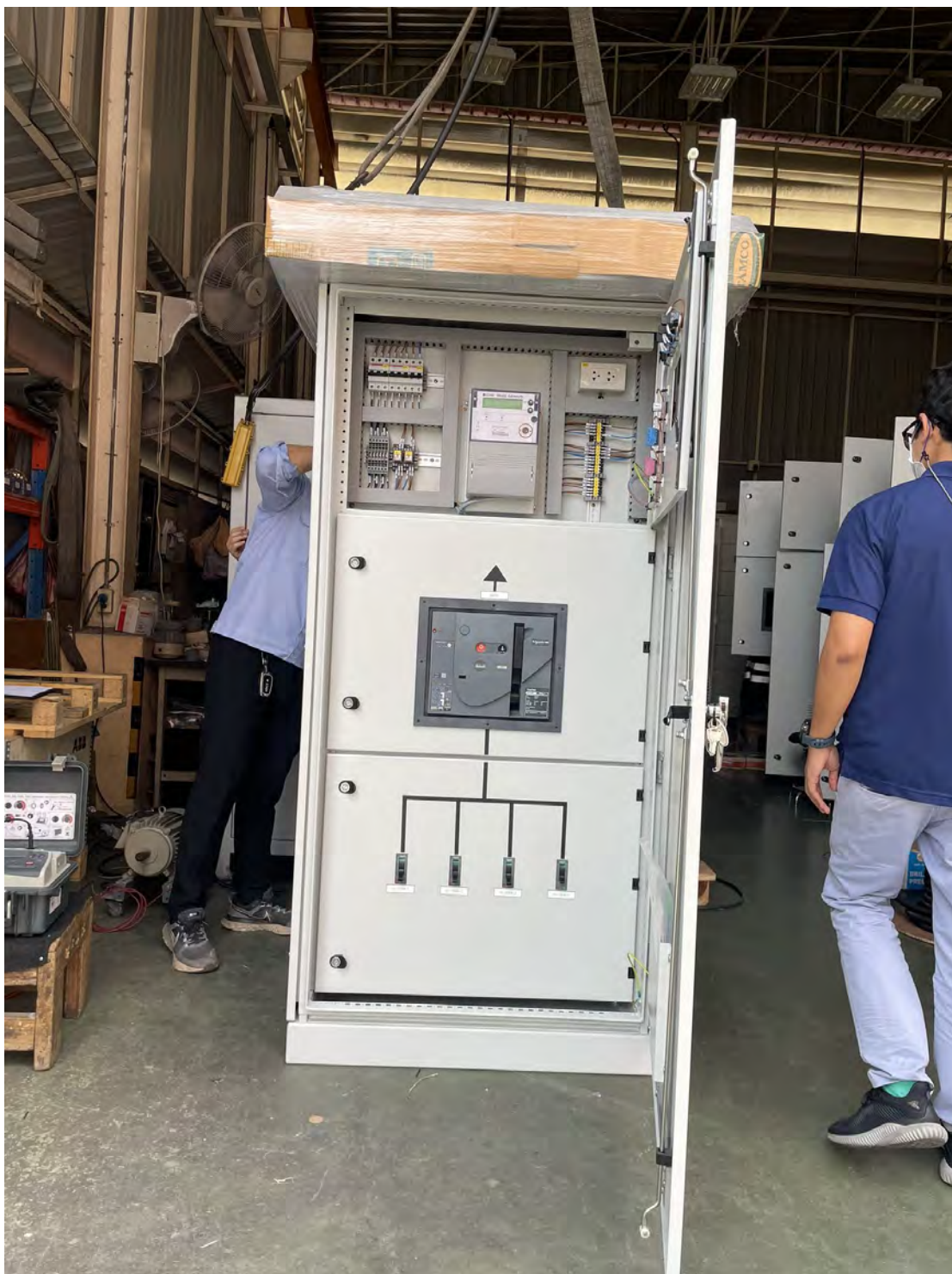
รูปที่ 8 ตรวจสอบภาพรวมทั้งหมดของตู้ไฟฟ้า โดยมีลูกค้ามาร่วมตรวจสอบด้วย
