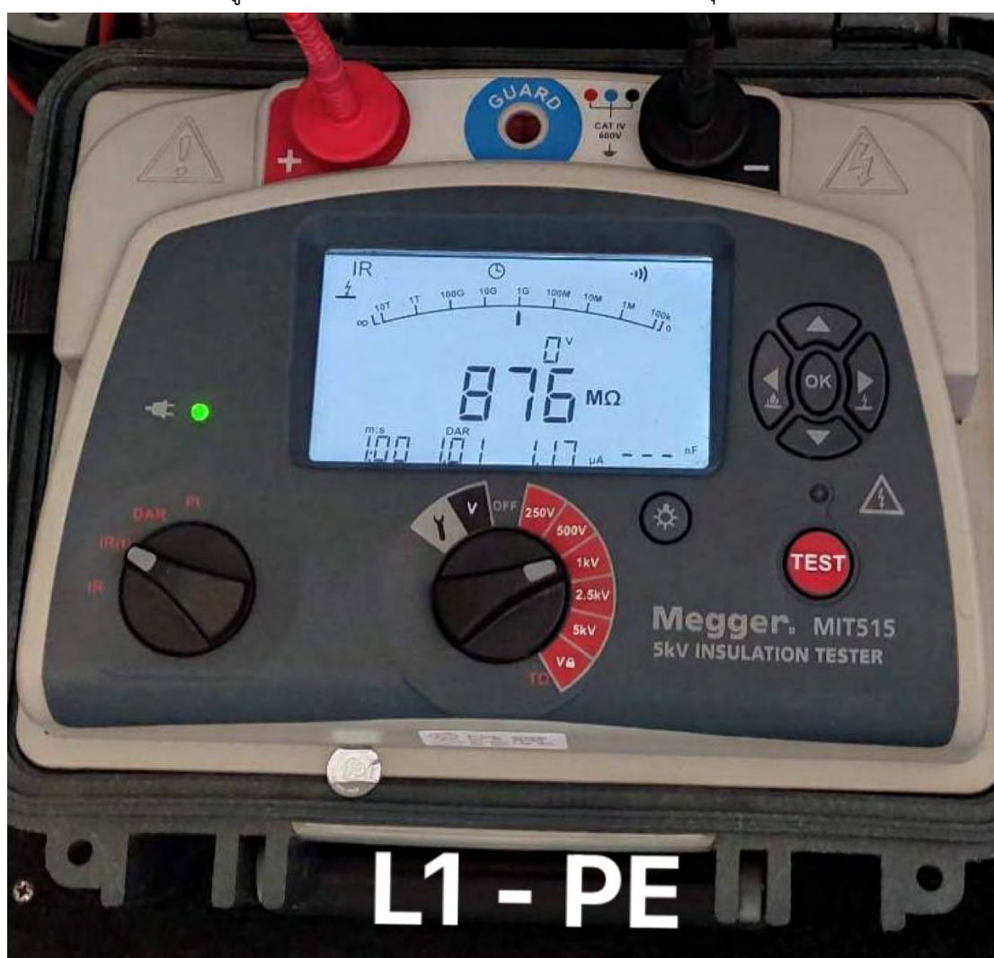
รูปที่ 4.30 ทดสอบค่าความเป็นฉนวนของ L1-PE
