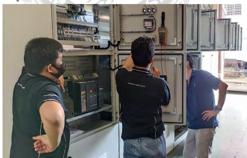
รูปที่ 4.28 ทดสอบระบบอุปกรณ์วงจรของหน้าสวิตช์บอร์ด
