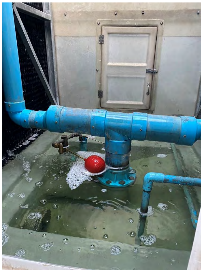
รูปที่ 4.26 การตรวจเช็คระดับของน้ำของ Cooling Tower No.1
