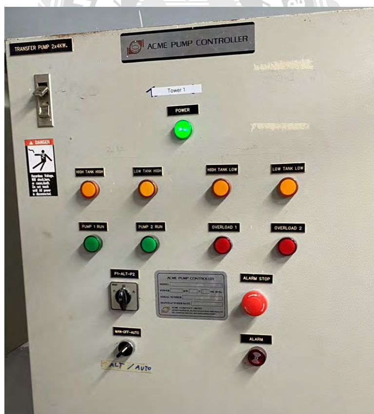
รูปที่ 4.23 การตรวจเช็คการทำงานของตู้ควบคุม Transfer Pump ของตึก 1
