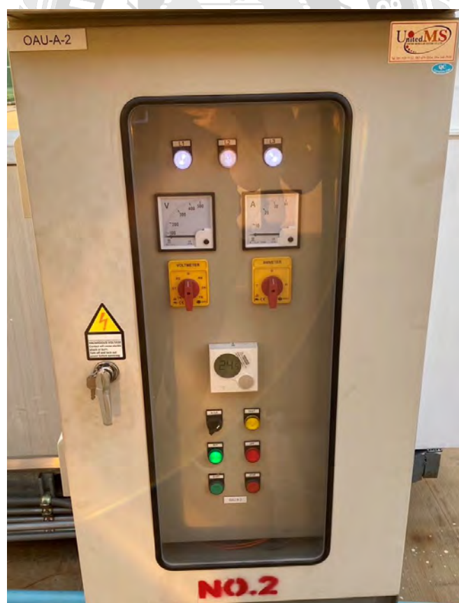
รูปที่ 4.39 การตรวจเช็คการทำงานของ OAU No.2 ของตึก 1
