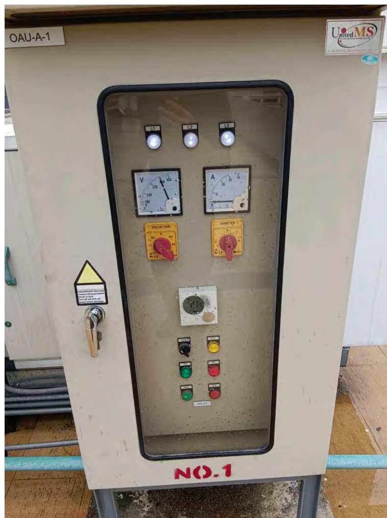
รูปที่ 4.40 การตรวจเช็คการทำงานของ OAU No.1 ของตึก 1
