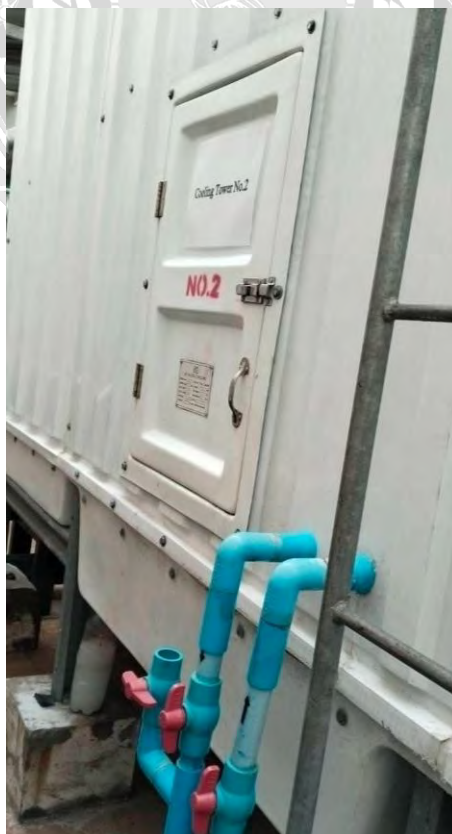
รูปที่ 4.29 การตรวจเช็คระดับของน้ำของ Cooling Tower No.2
