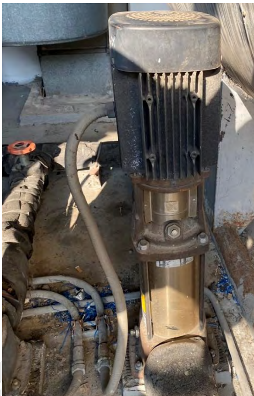
รูปที่ 4.36 การตรวจเช็คการทำงานของ Return Pump ตึก 2
