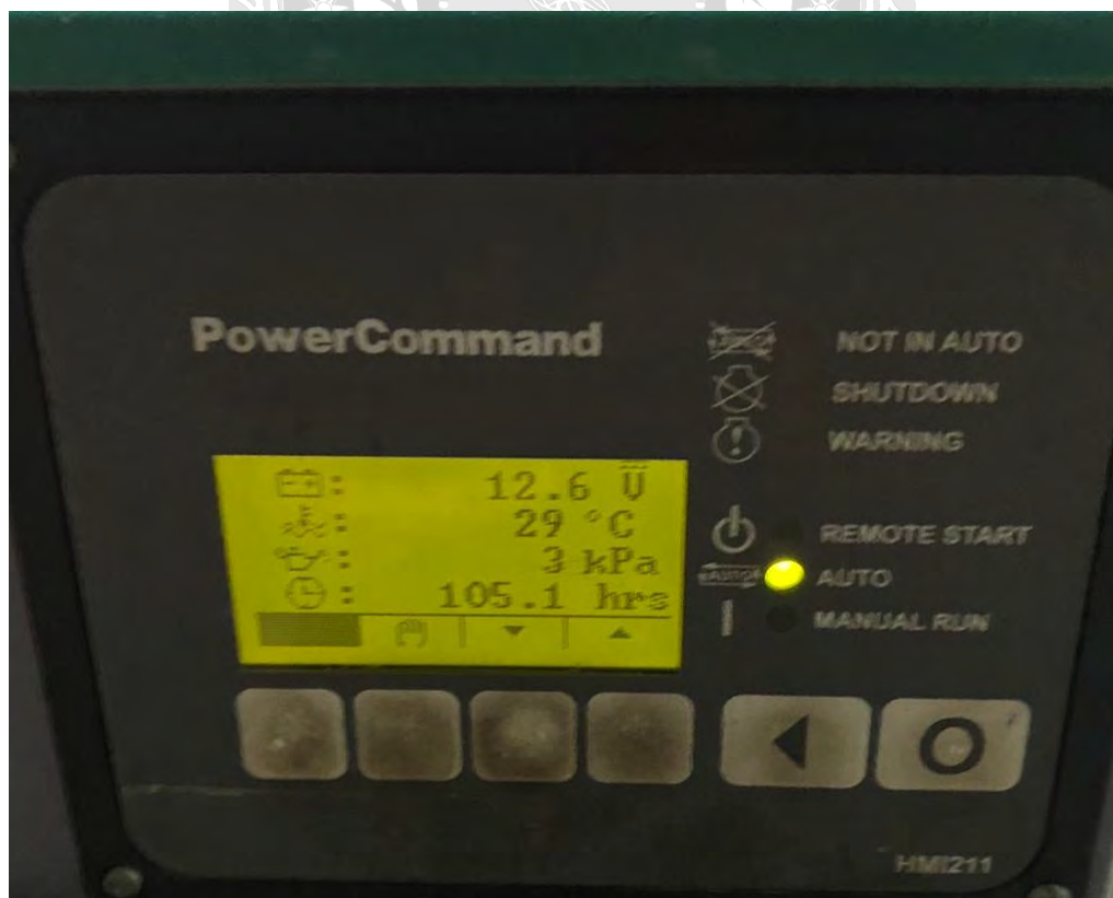
รูปที่ 4.25 การตรวจเช็คการทำงานของเครื่อง Generator ของตึก 2
