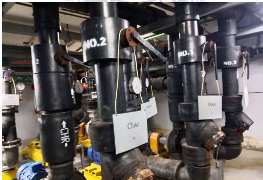
รูปที่ 4.17 การตรวจเช็คการทำงานของ Chiller Pump
