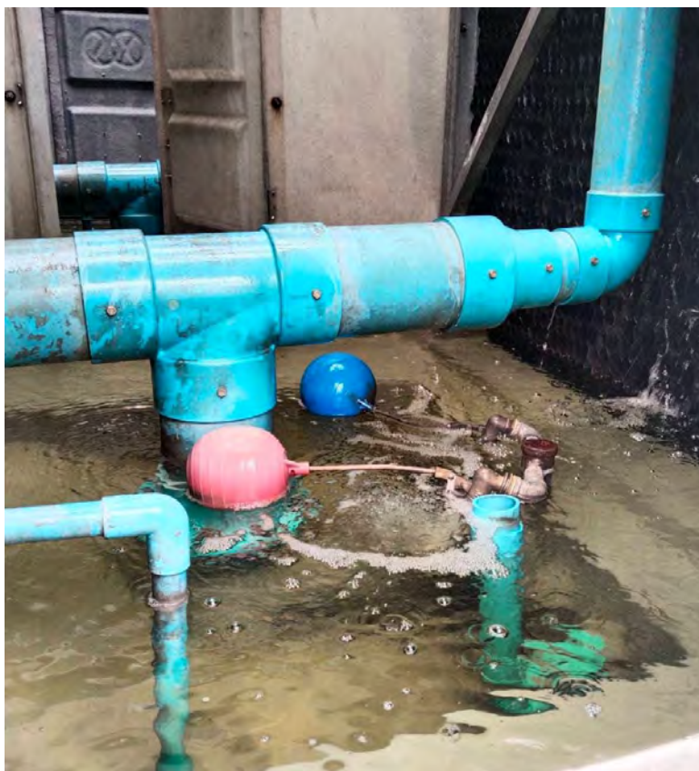
รูปที่ 4.28 การตรวจเช็คระดับของน้ำของ Cooling Tower No.2
