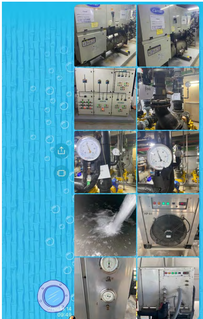
รูปที่ 4.42 ทำการถ่ายรูปเครื่องจักรต่างๆและรายงานลงไปในกลุ่มไลน์ของช่างโรงแรม
