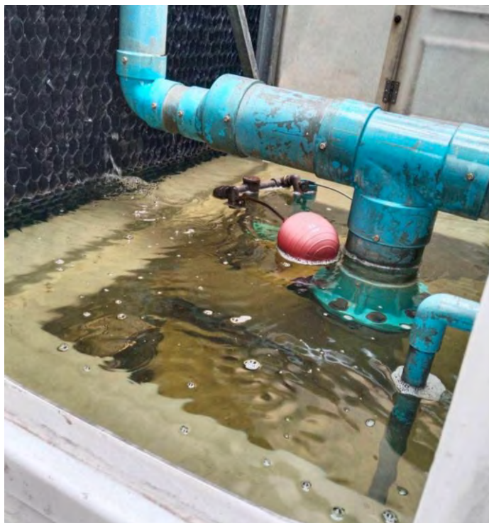
รูปที่ 4.30 การตรวจเช็คระดับของน้ำของ Cooling Tower No.3
