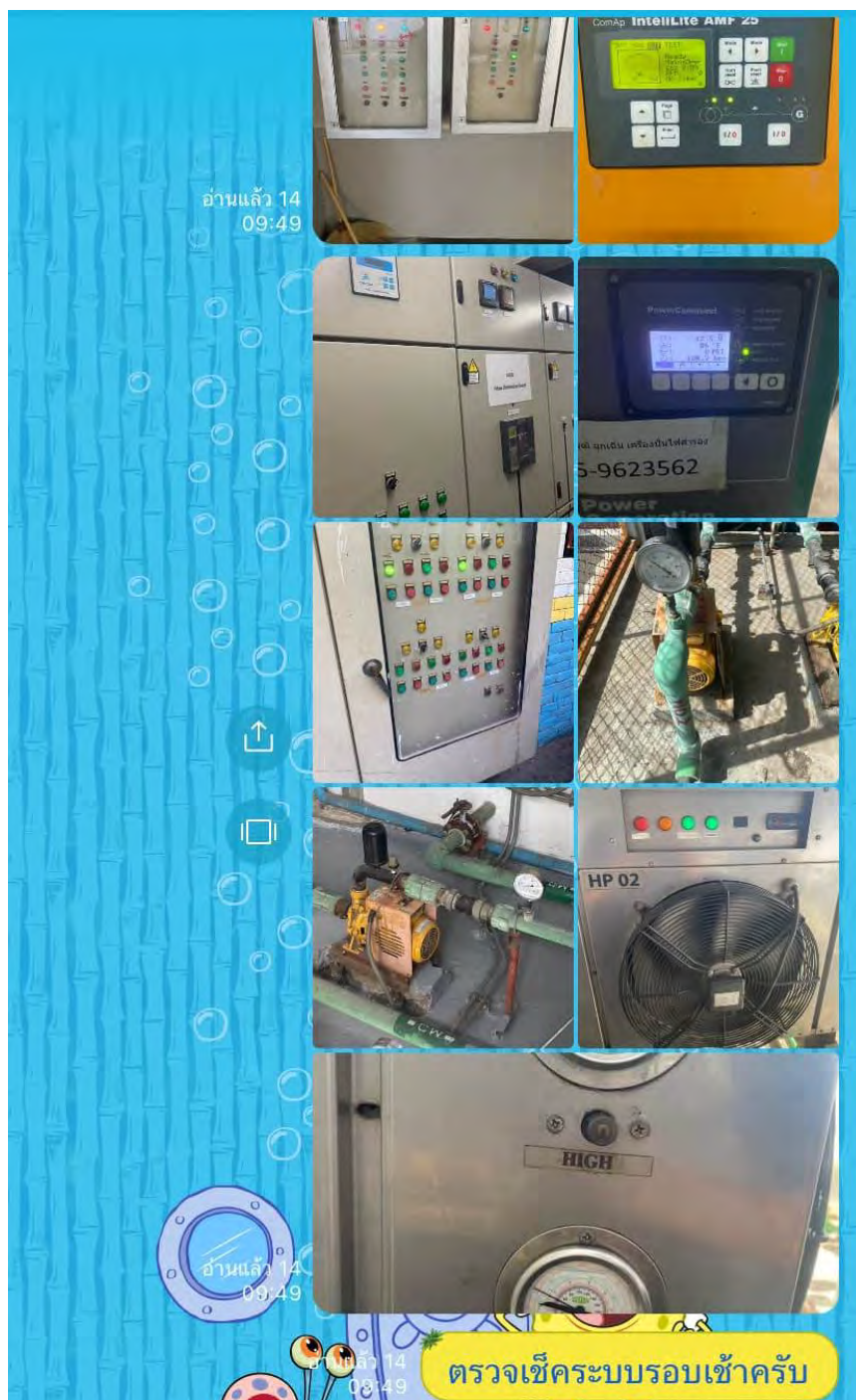
รูปที่ 4.43 ทำการถ่ายรูปเครื่องจักรต่างๆและรายงานลงไปในกลุ่มไลน์ของช่างโรงแรม
