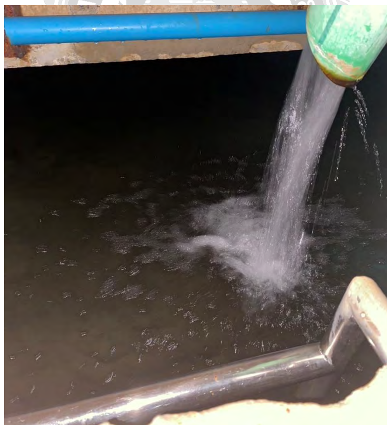
รูปที่ 4.19 การตรวจเช็คระดับน้ำของ Underground Tank
