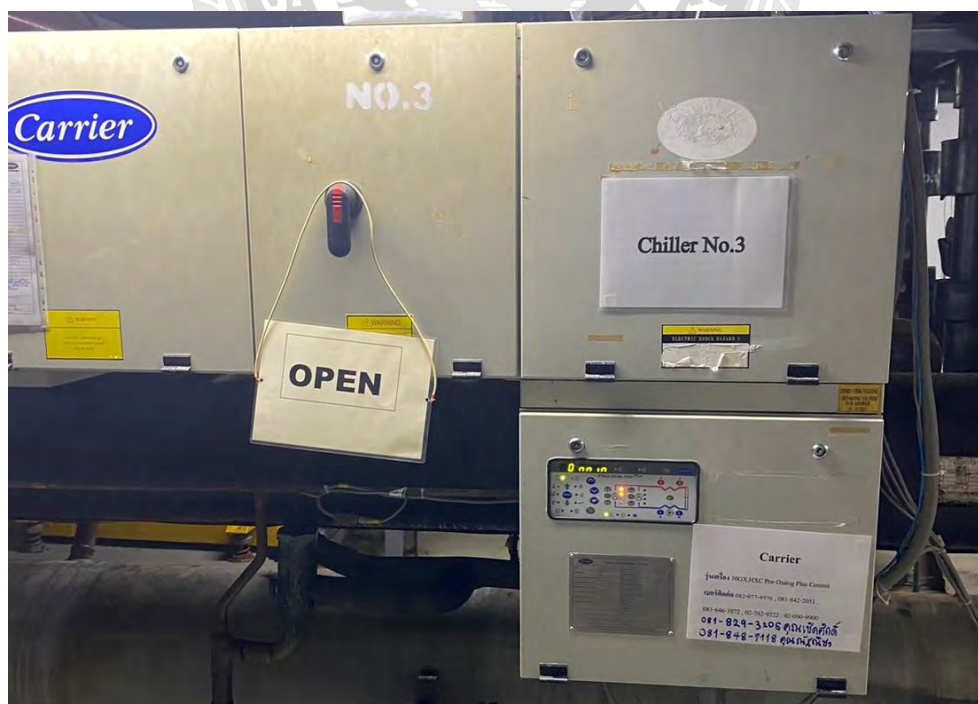
รูปที่ 4.15 การตรวจเช็คการทำงานของเครื่อง Chiller
