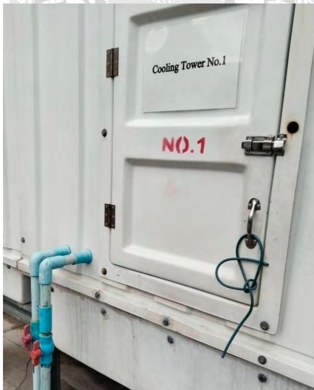
รูปที่ 4.27 การตรวจเช็คระดับของน้ำของ Cooling Tower No.1
