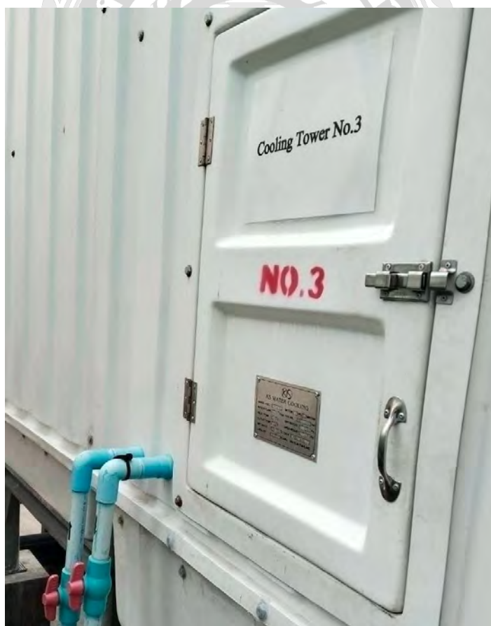
รูปที่ 4.31 การตรวจเช็คระดับของน้ำของ Cooling Tower No.3
