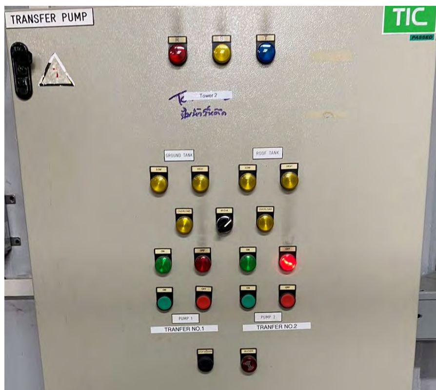
รูปที่ 4.22 การตรวจเช็คการทำงานของตู้ควบคุม Transfer Pump ของตึก 2
