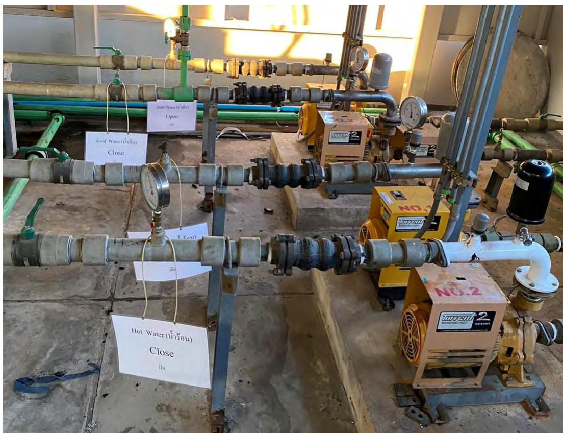
รูปที่ 4.32 การตรวจเช็คการทำงานของ Booster Pump น้ำร้อนและน้ำเย็นของตึก 1
