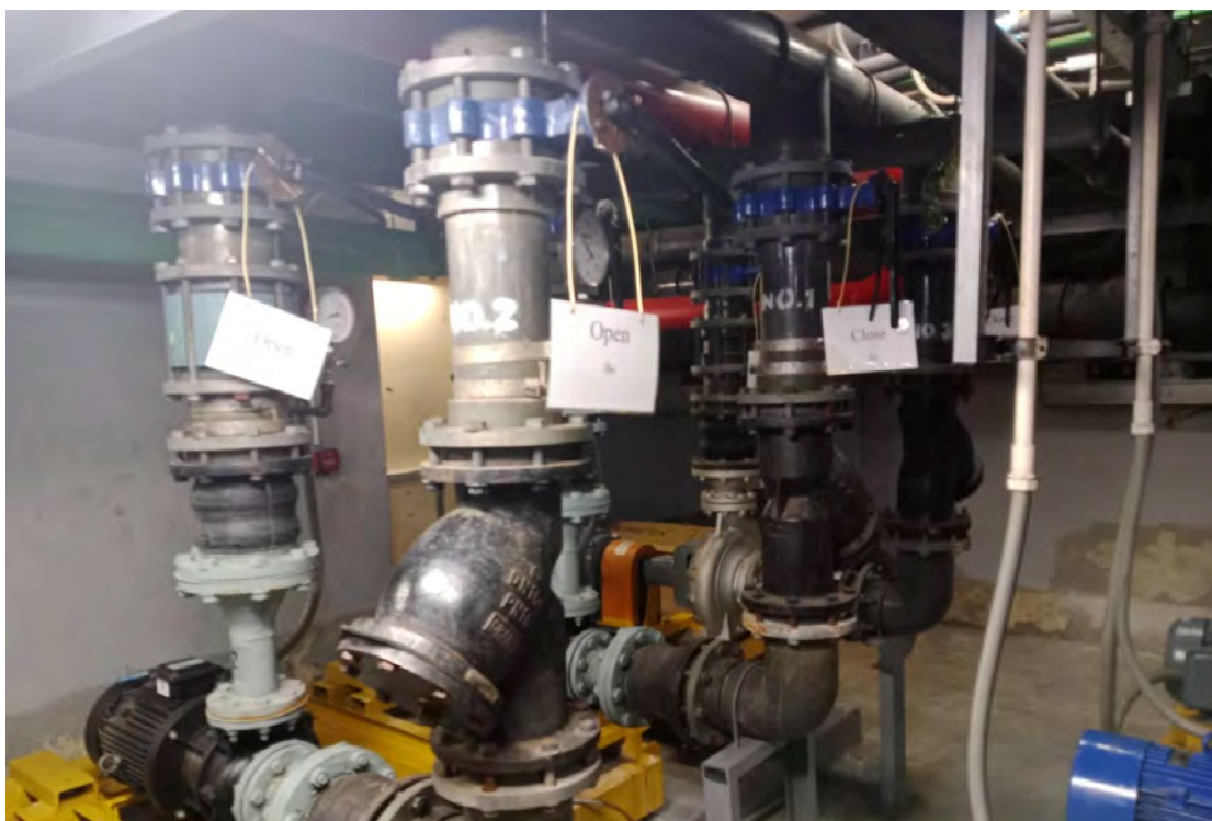
รูปที่ 4.18 การตรวจเช็คการทำงานของ Condenser Pump
