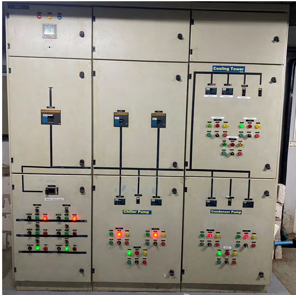
รูปที่ 4.16 การตรวจเช็คการทำงานของแผงควบคุมเครื่องจักรในห้อง Chiller
