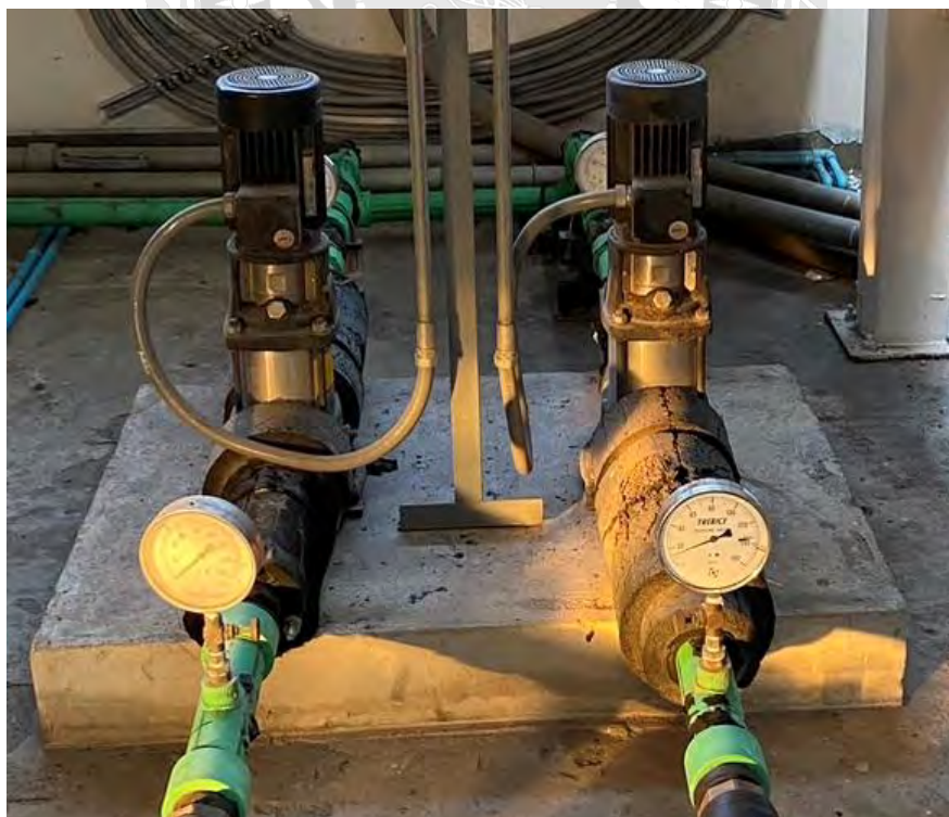
รูปที่ 4.33 การตรวจเช็คการทำงานของ Return Pump ตึก 1
