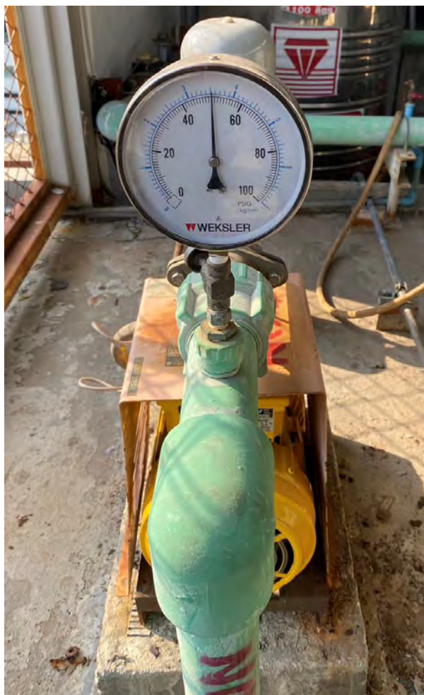
รูปที่ 4.34 การตรวจเช็คการทำงานของ Booster Pump น้ำร้อน ตึก 2
