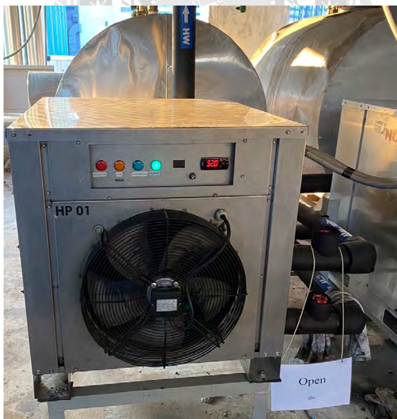
รูปที่ 4.37 การตรวจเช็คการทำงานของ Heat Pump ตึก 1
