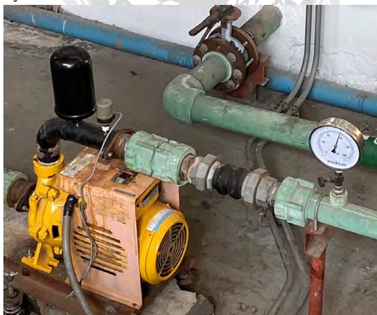
รูปที่ 4.35 การตรวจเช็คการทำงานของ Booster Pump น้ำเย็น ตึก 2
