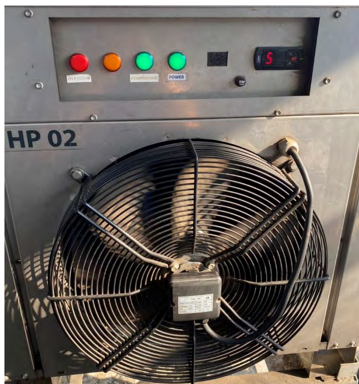
รูปที่ 4.38 การตรวจเช็คการทำงานของ Heat Pump ตึก 2
