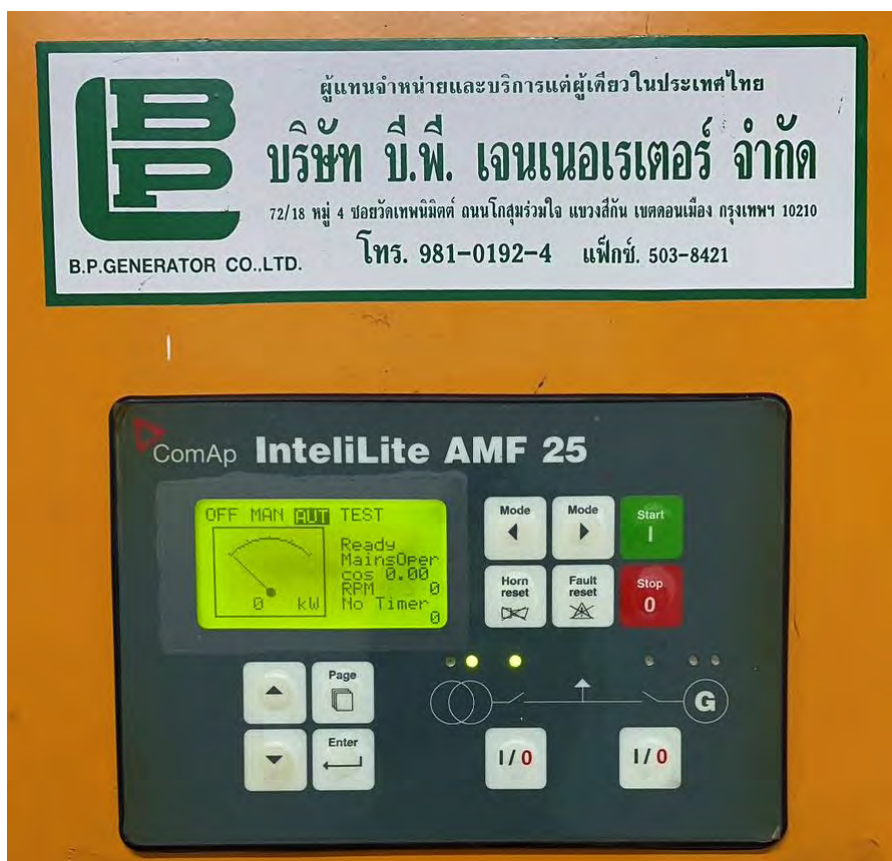
รูปที่ 4.24 การตรวจเช็คการทำงานของเครื่อง Generator ของตึก 1
