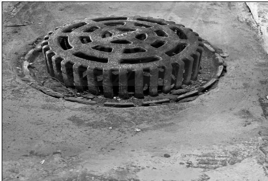
รูปที่ 4.10 การติดตั้งชุดหัวระบายน้ำ รุ่น 327
