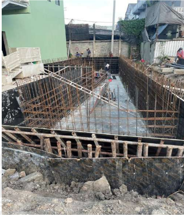
รูปที่ ข.1 การทำบ่อสำรองน้ำรับน้ำจากมิเตอร์ของการประปาแบบบ่อ คสล.
