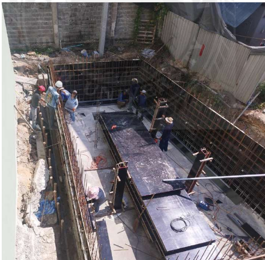
รูปที่ 2.8 ถังเก็บน้ำประปาสำรองแบบป็อคสล.
