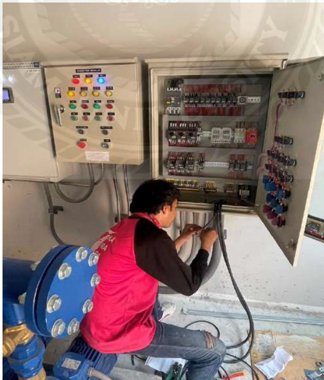
รูปที่ ข.8 การเดินระบบไฟฟ้าตู้ควบคุมปั๊มส่งน้ำประปา (Transfer Pump)
