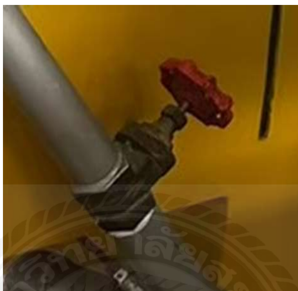
รูปที่ 3.45 หมายเลข 5 วาล์วปรับแรงดัน Gate Valve
