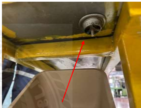
รูปที่ 3.15 จุดระบายบริเวณถังพัก น้ำมีการรั่วซึม
