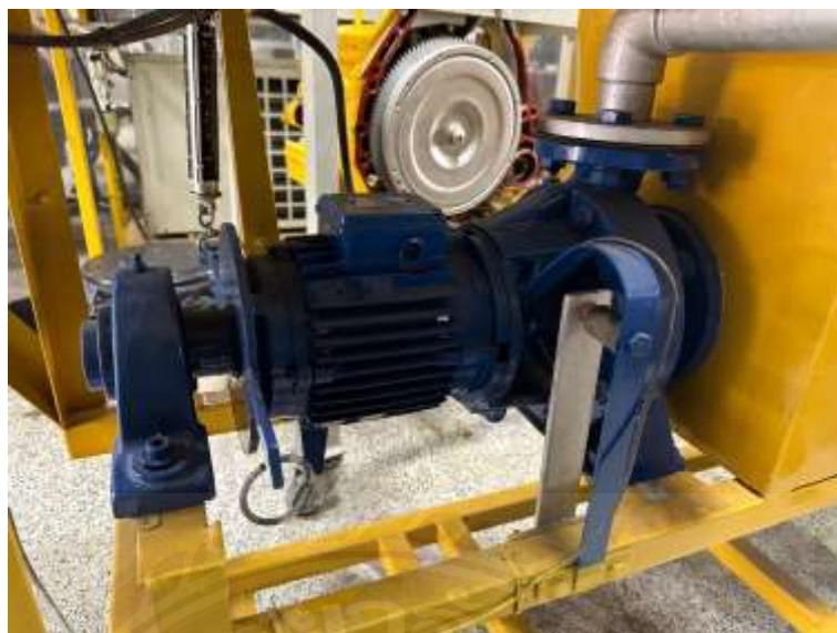
รูปที่ 3.4 Pump Calpeda
