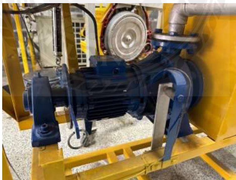
รูปที่ 3.42 หมายเลข 2 Pump Calpeda
