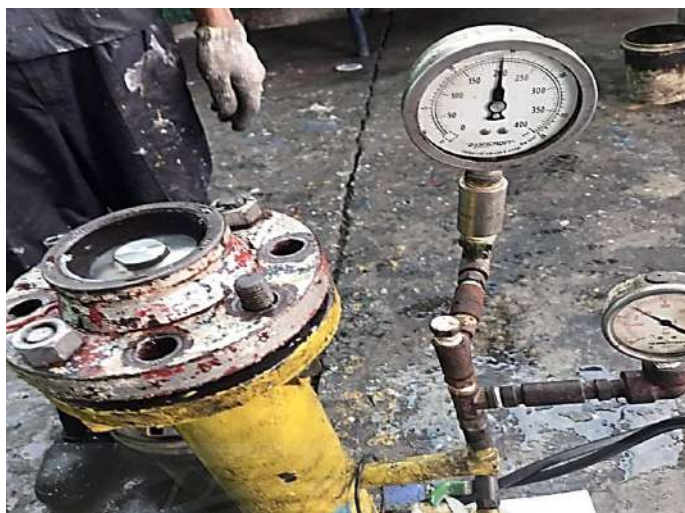
รูปที่ 5.10 Hydro static relief valve ปิด และ Pressure gauge ขณะ Hydro static relief valve ปิด
