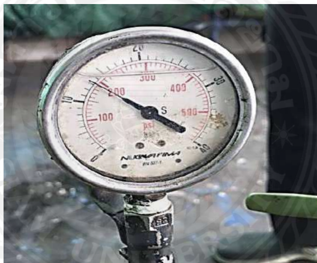
รูปที่ 5.7 Pressure gauge ขณะ Internal Safety relief valve ปิด
