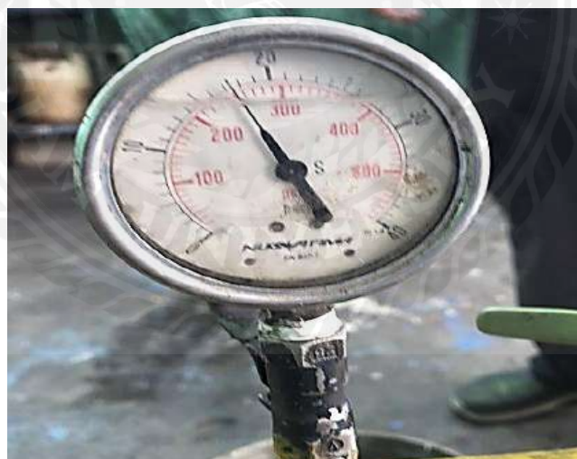
รูปที่ 5.5 Pressure gauge ขณะ Internal Safety relief valve เปิด
