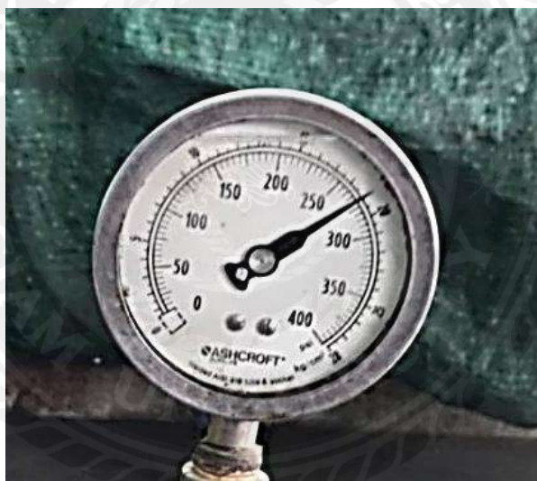
รูปที่ 5.9 Pressure gauge ขณะ Hydro static relief valve เปิด
